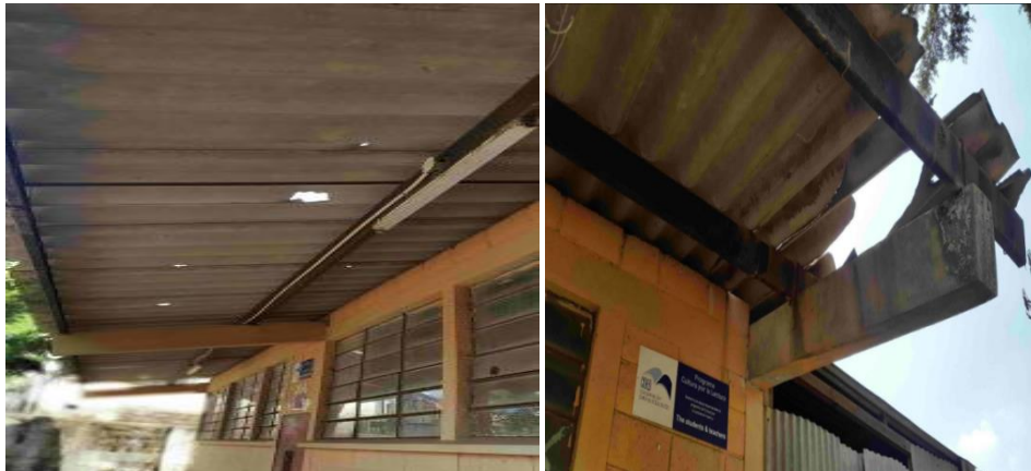
Imagen 1 Deterioro de la infraestructura educativa Escuela Oficial Rural Mixta, Caserío La Trompeta
