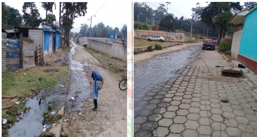
Imagen No. 1 Drenaje frente al INED El Tejar, Chimaltenango 2020
