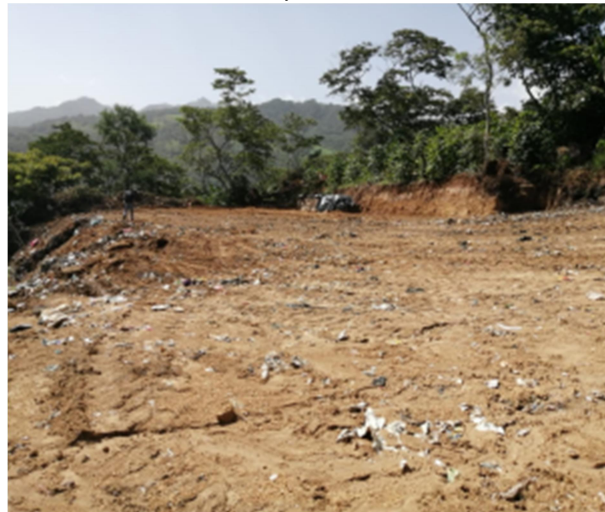
Figura 3. Habilitación Basurero Municipal ubicado en la Aldea Las Minas, Casillas, Santa Rosa
