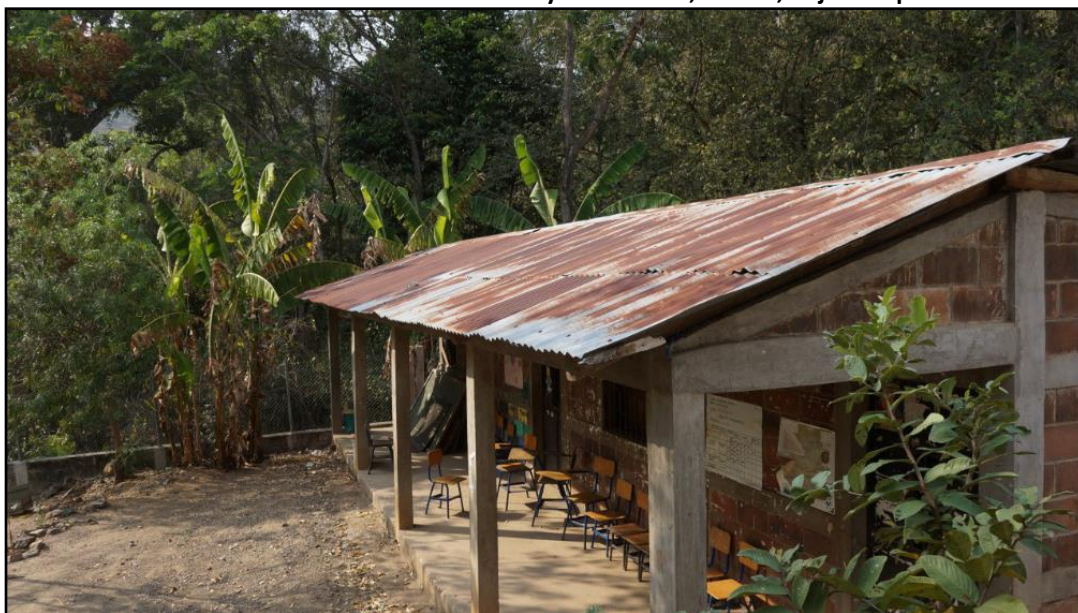
Fotografía No. 1 Escuela deteriorada Aldea Lo de Reyes año 2018, El Chol, Baja Verapaz
