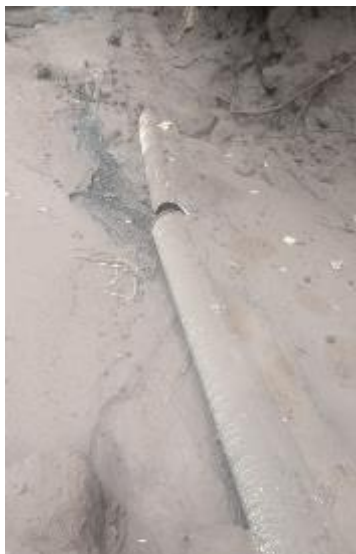
Imagen 17. Línea de conducción dañada. Sistema de agua potable. Caso urbano Santa Lucía Cotzunalguapa.
