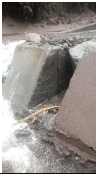
Imagen 18. Presa dañada. Sistema de agua potable. Caso Urbano Santa Lucia
