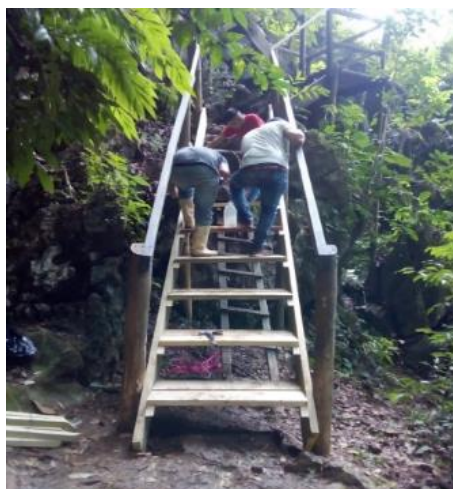
IMAGEN 6. DAÑOS EN LA INFRAESTRUCTURA EN EL MONUMENTO NACIONAL SEMUC CHAMPEY
