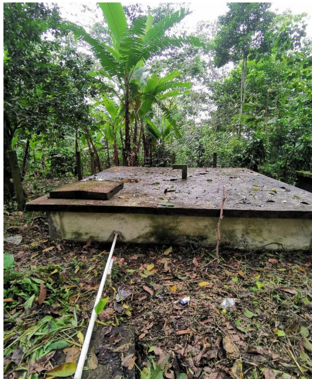
Fotografía 3: Vista de la no existencia de sistema de desinfección
