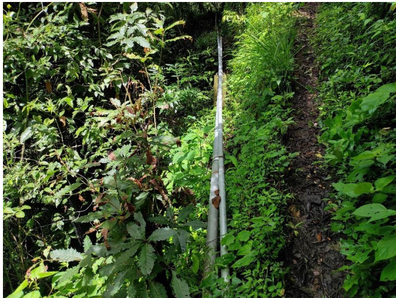
Fotografía 6 de riesgo en línea de conducción 2
