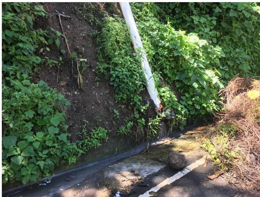
Fotografía 12 Riesgo puntos de desfogue de aguas residuales 2
