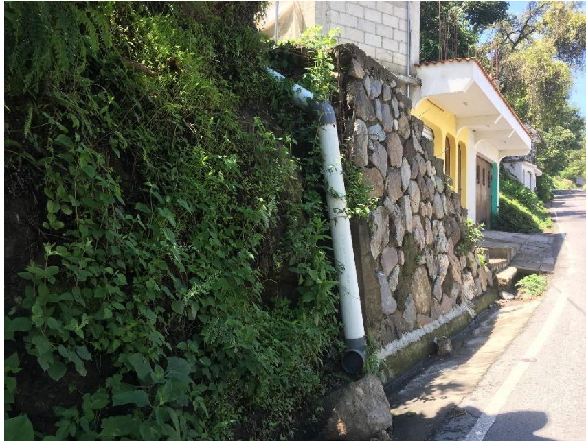
Fotografía 13 Riesgo puntos de desfogue de aguas residuales 3
