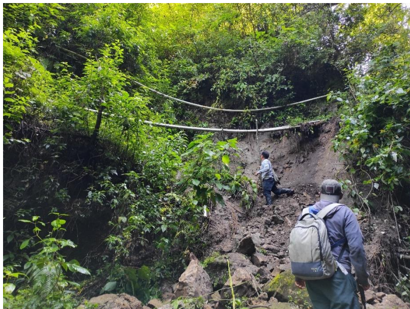
Fotografía 5 de riesgo en línea de conducción
