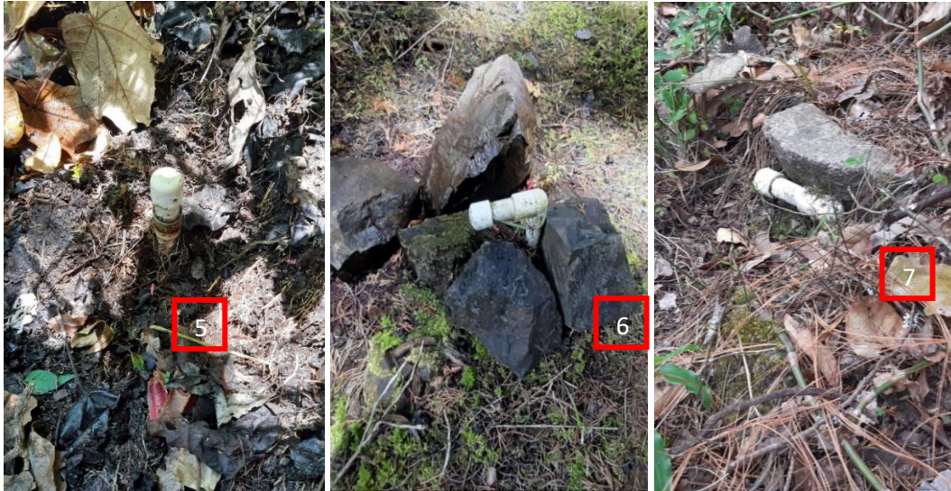
Fotografía 3. Accesorios en línea de conducción
