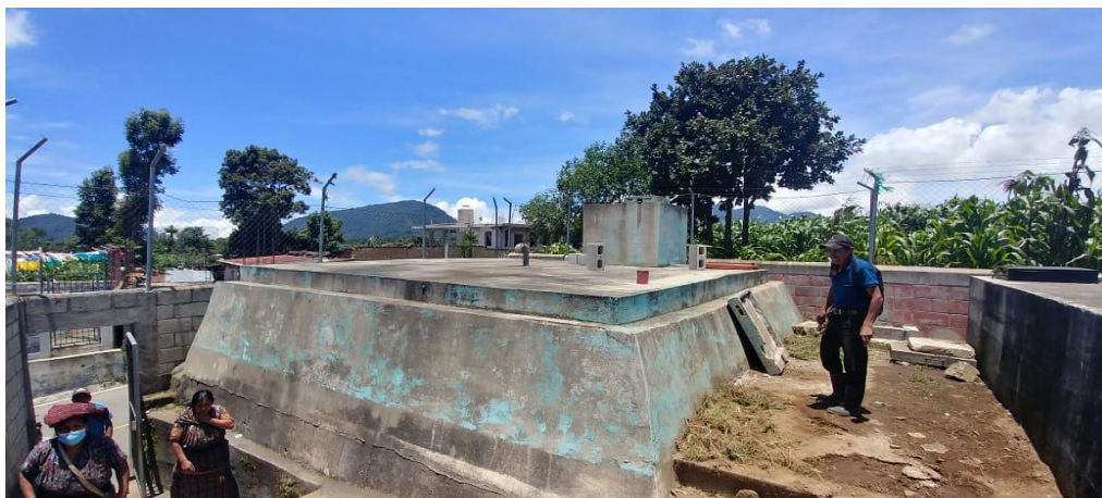
Ilustración 7: Vista del tanque de almacenamiento donde no existe sistema de desinfección
