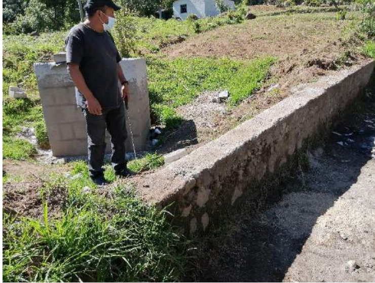
Fotografía 5 Caja reunidora de caudales y muro de protección contra crecidas
