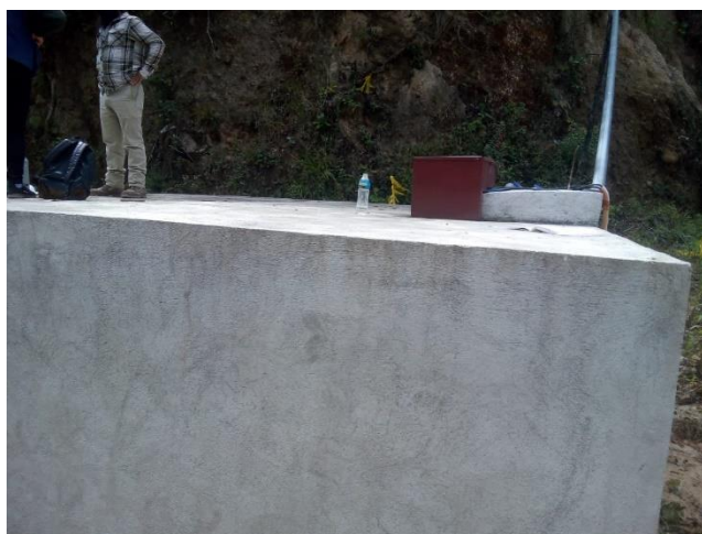
Fotografía 4. No existe espacio físico para sistema de desinfección. Elaboración propia.
