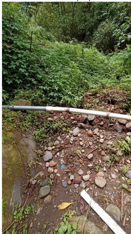
Fotografía 3. Riesgo de rotura en línea de conducción por malas prácticas en construcción de red. Elaboración propia.
