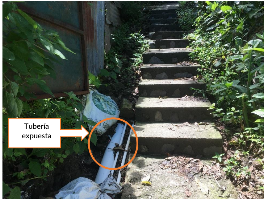
Ilustración 8: Fotografía de riesgo tubería de distribución 2
