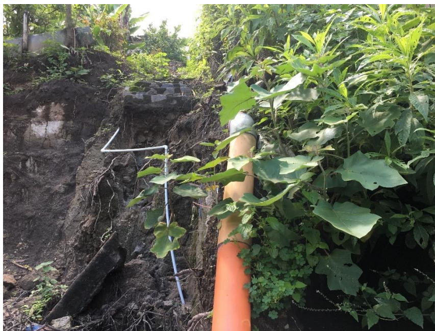
Ilustración 11: Fotografía de riesgo puntos de desfogue de aguas residuales
