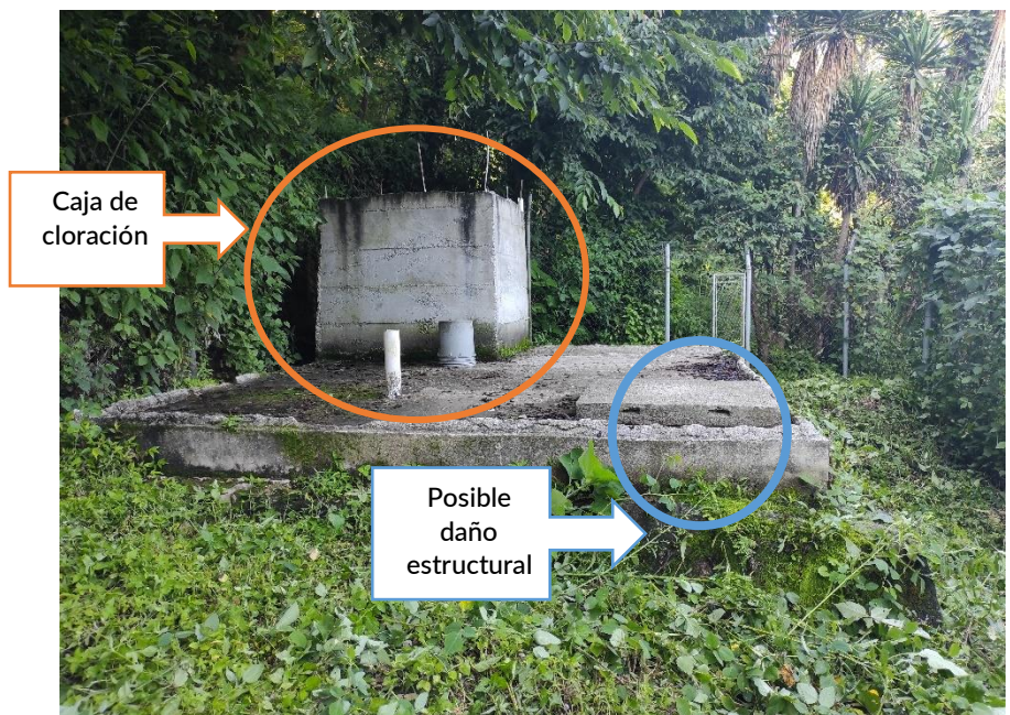
Ilustración 6: Fotografía de riesgo caja de cloración en tanque de almacenamiento
