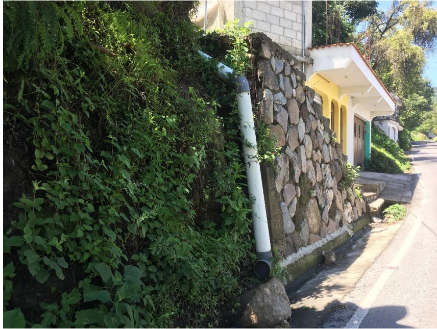
Ilustración 13: Fotografía de riesgo puntos de desfogue de aguas residuales 3
