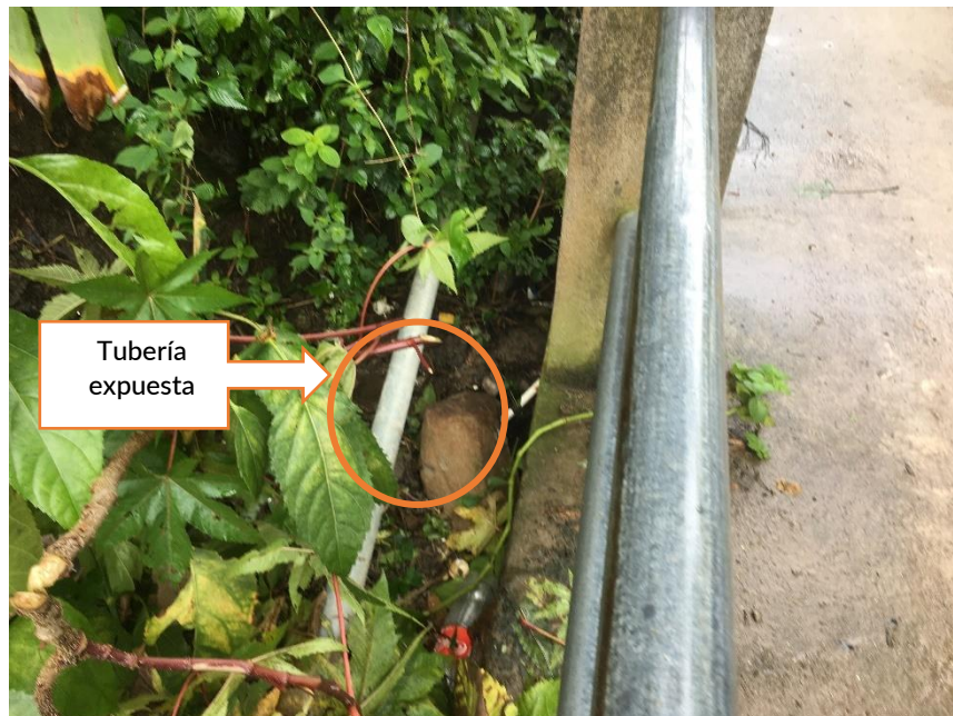
Ilustración 7: Fotografía de riesgo tubería de distribución
