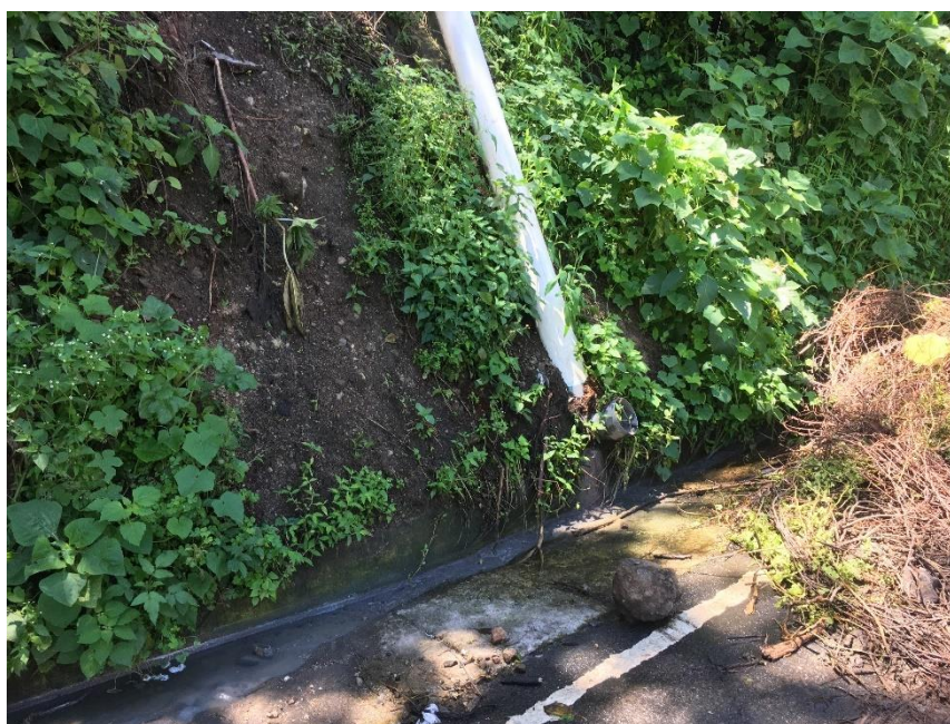
Ilustración 12: Fotografía de riesgo puntos de desfogue de aguas residuales 2
