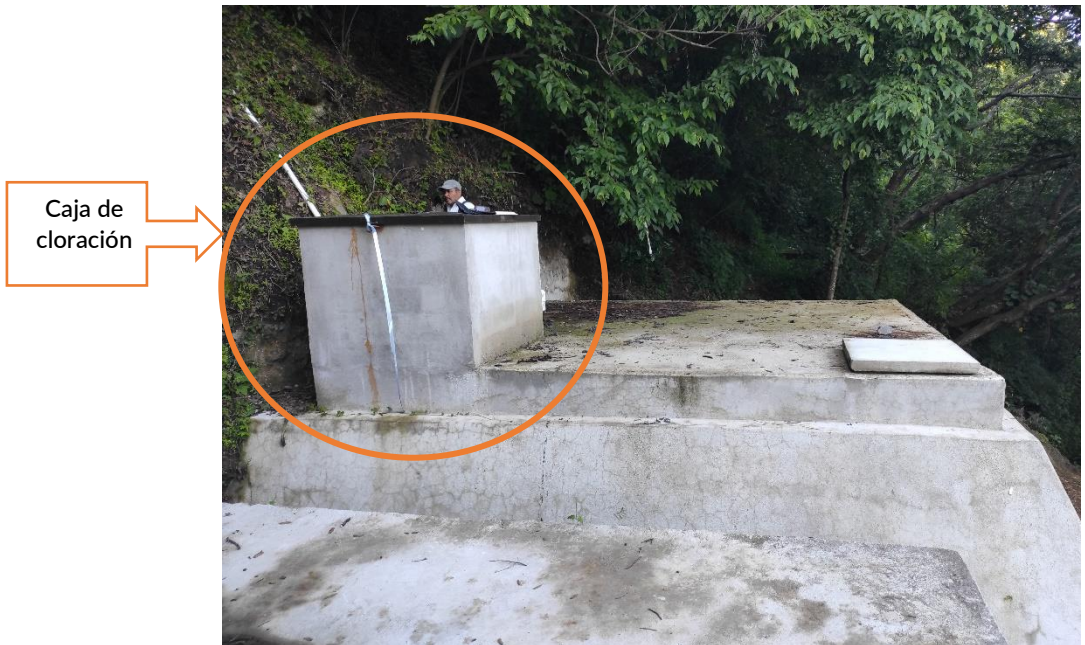
Ilustración 5: Fotografía de riesgo caja de cloración en tanque de almacenamiento
