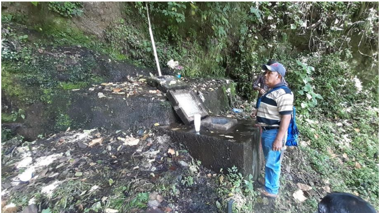
Ilustración 5: Fotografía de riego en la captación No. 2
