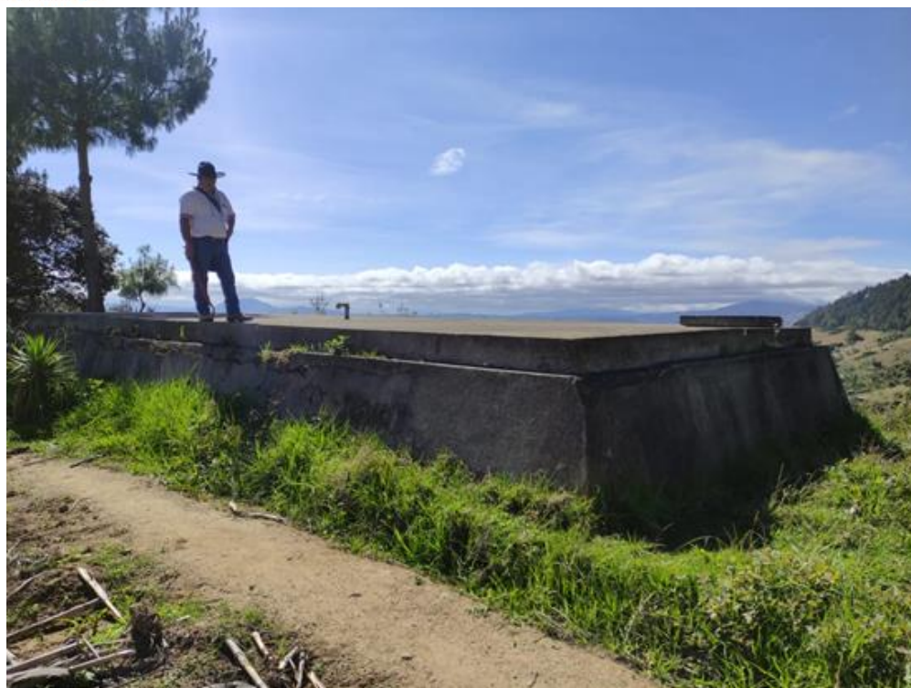
Ilustración 8: Fotografía del tanque de distribución de las Canoas Bajas y Altas
