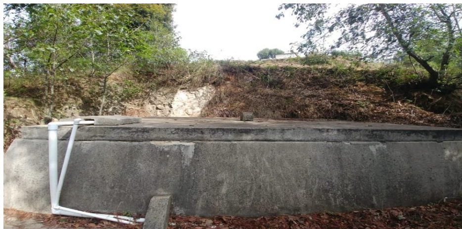
Ilustración 7. Vista del tanque de almacenamiento donde no existe sistema de desinfección
