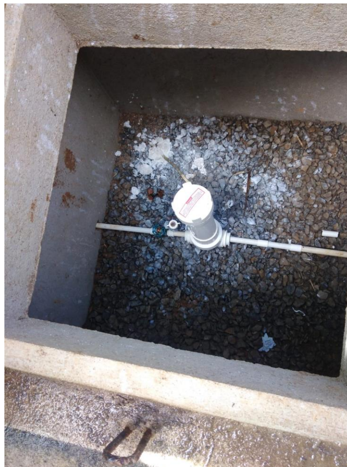
Figura 5 Sistema de desinfección
