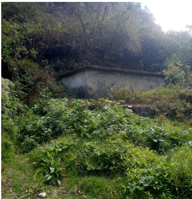
Fotografía 4. Tanque de distribución Elaboración propia.
