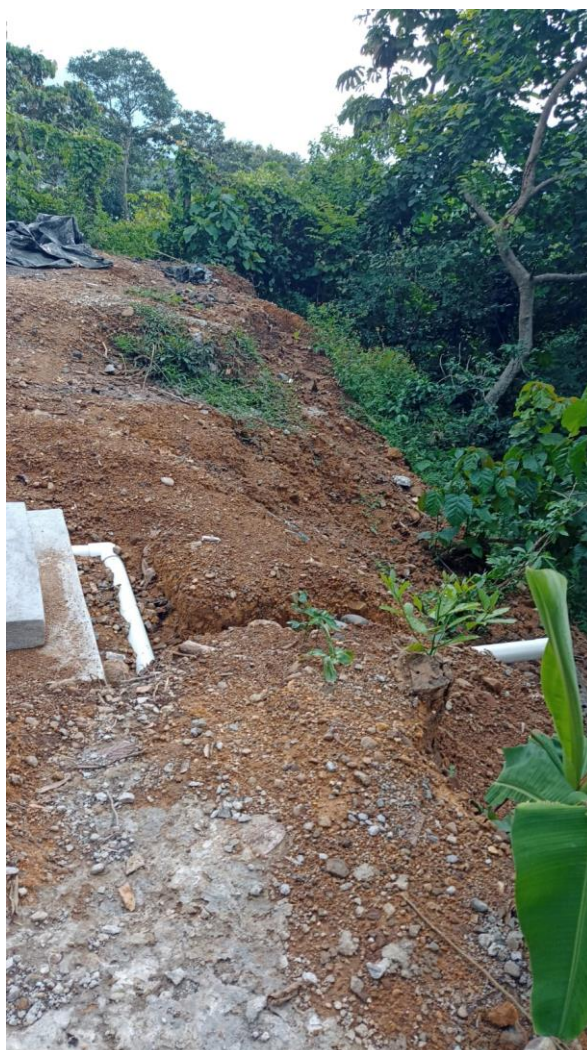
Fotografía 2. Talud aledaño a plataforma de tanque de distribución, pudo observarse riesgo de derrumbe.
