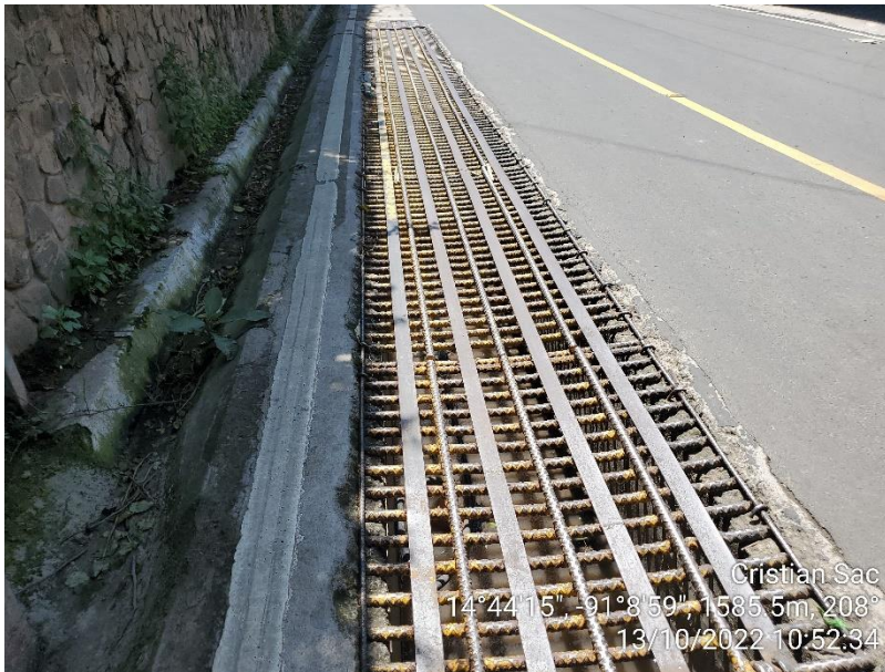
Fotografía 15 Rejilla para agua pluvial
