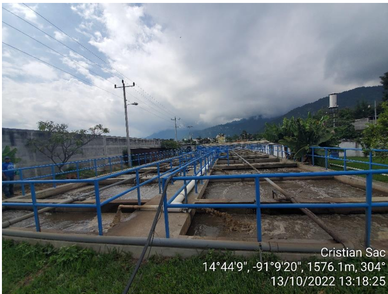
Fotografía 18 Planta de tratamiento de aguas residuales 3
