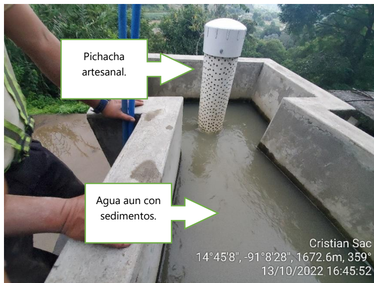
Fotografía 9 Riesgo ingreso de agua contaminada
