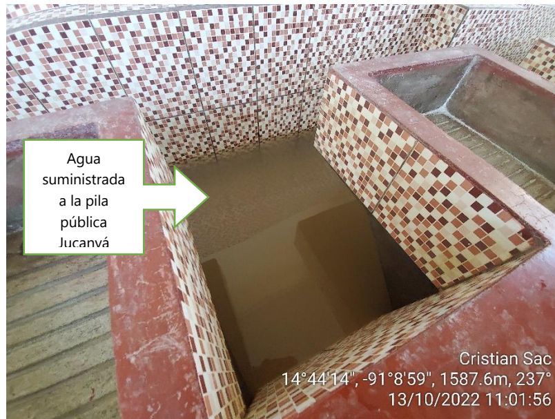
Fotografía 10 Riesgo agua contaminada en pilas públicas.
