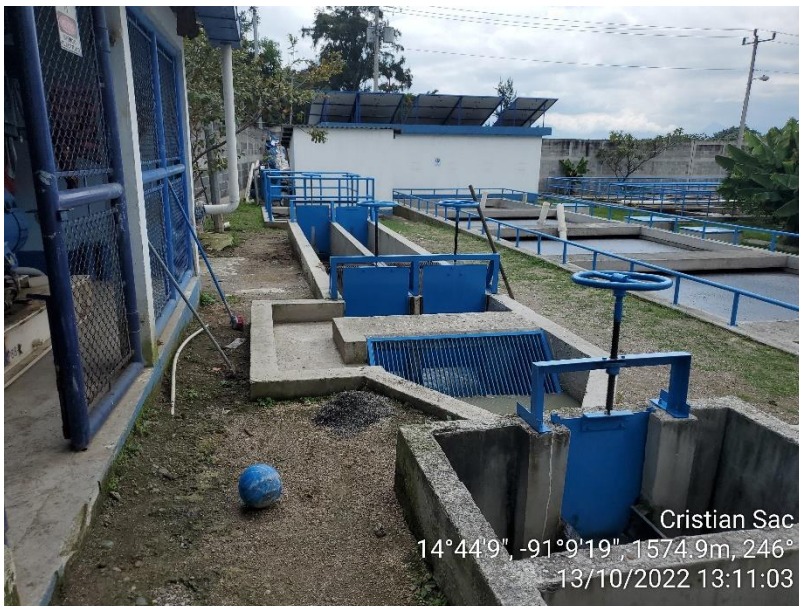
Fotografía 16 Planta de tratamiento de aguas residuales
