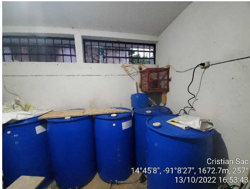
Fotografía 6 Riesgo sistema de desinfección.
