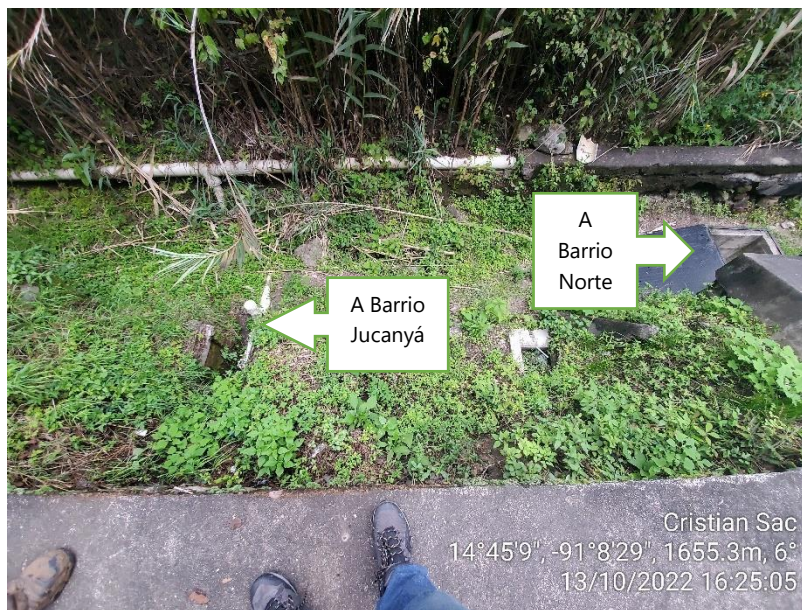
Fotografía 7 Riesgo sistema de almacenamiento sistema por gravedad
