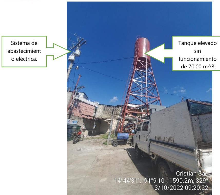
Fotografía 8 Riesgo Sistema de almacenamiento tanque aéreo
