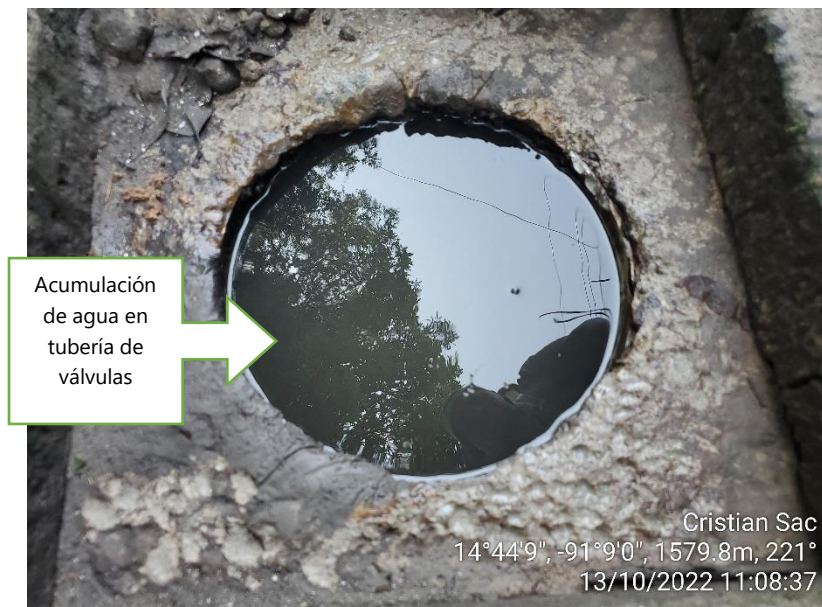
Fotografía 12 Riesgo agua contaminada en válvulas
