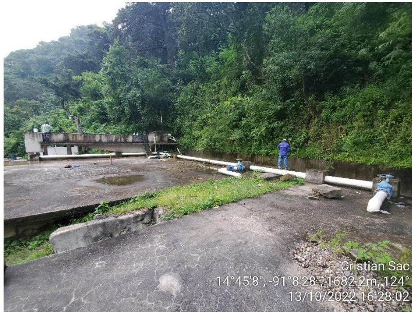
Fotografía 5 Desarenador e interconexiones entre tanques de almacenamiento
