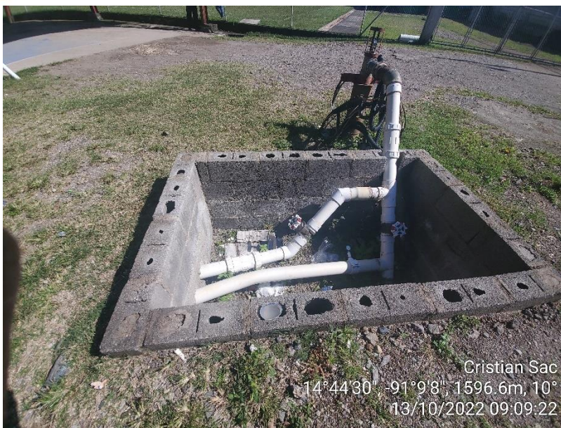
Fotografía 2 Riesgo pozo principal
