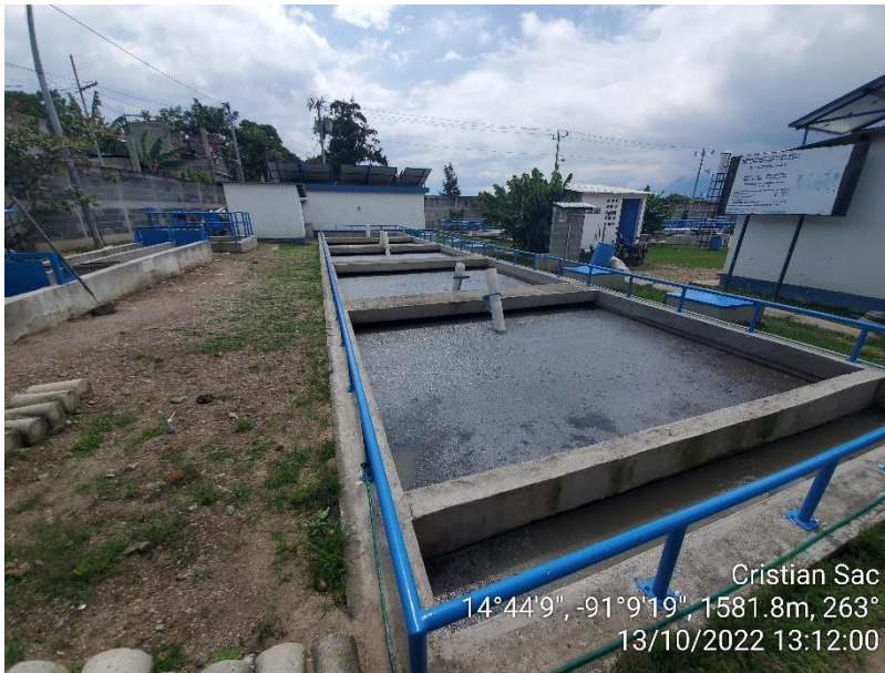
Fotografía 17 Planta de tratamiento de aguas residuales 2
