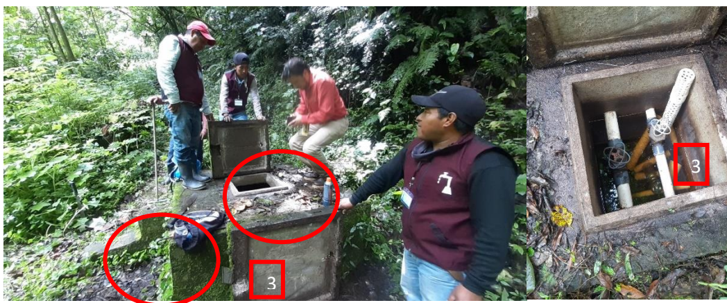
Fotografía 2. Caja reunidora de caudales y su caja de válvulas
