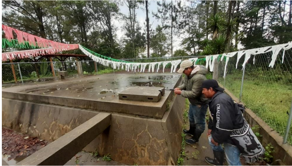
Fotografía 3. Vista del tanque de almacenamiento
