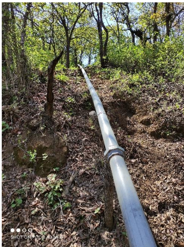
Ilustración 4: Fotografía de la línea de condición (tubería HG sin anclajes), Cantón Chitlul
