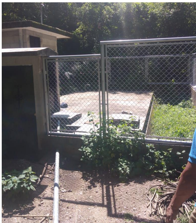
Figura 4 Tanque de succión
