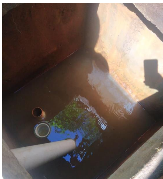
Figura 3 Caja de captación
