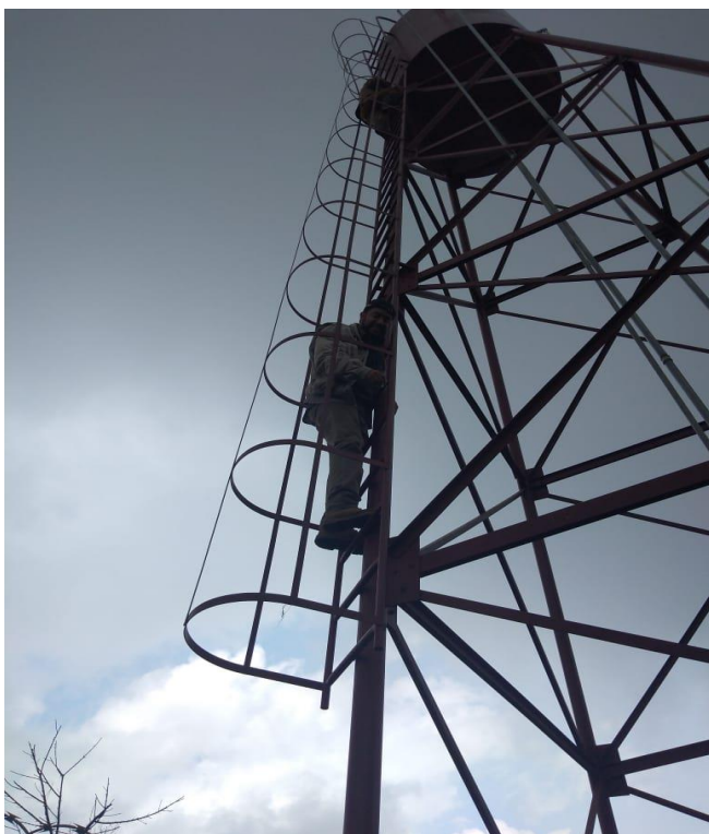
Figura 4 Tanque de distribución
