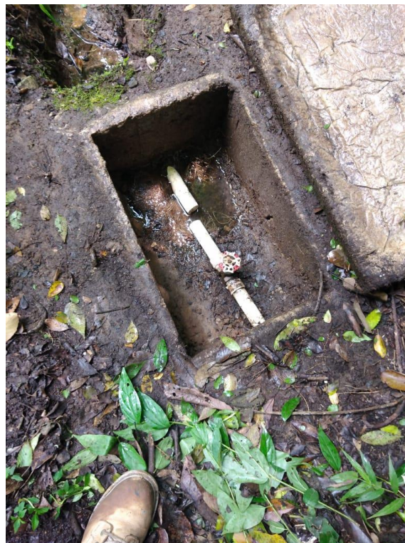
Figura 5 Línea de conducción (válvula en mal estado)
