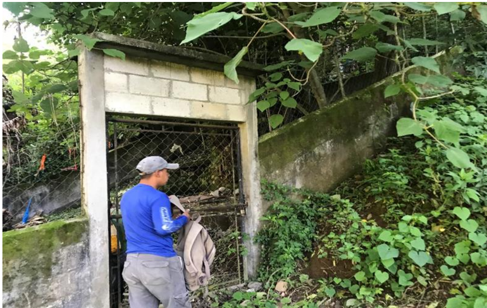
Ilustración 5. Vista de muro perimetral y portón de ingreso a la captación, donde se requiere limpieza.
