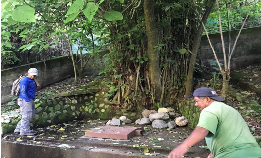
Ilustración 4. Obra de arte para la captación de la fuente, requiere realizar limpieza general de alrededores
