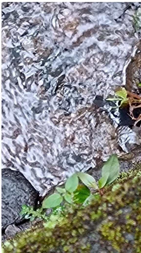
Fotografía 4. Fuga en captación hacia cuerpo de río aledaño. Elaboración propia.
