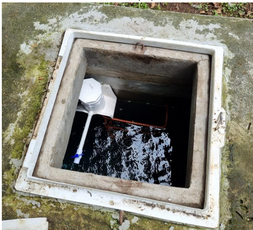
Fotografía 5. Existe sistema de desinfección pero no está en funcionamiento. Elaboración propia.
