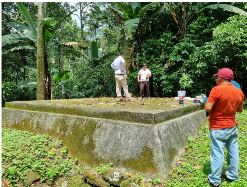
Fotografía 5. Tanque sin cerco perimetral. Elaboración propia.
