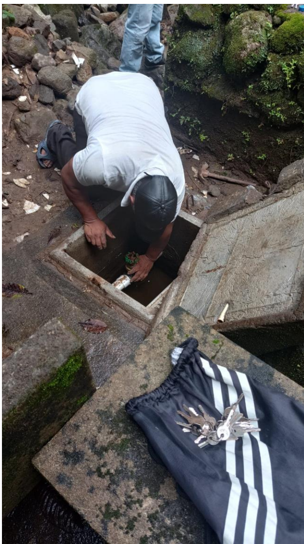
Fotografía 3. Llave de limpieza de fuente descompuesta. Elaboración propia.
