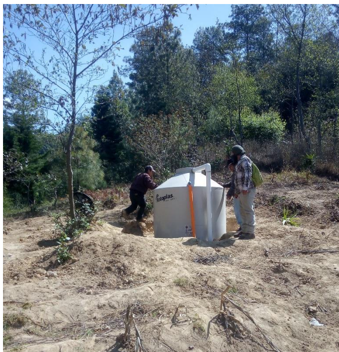
Fotografía 3. Tanque de distribución Elaboración propia.
