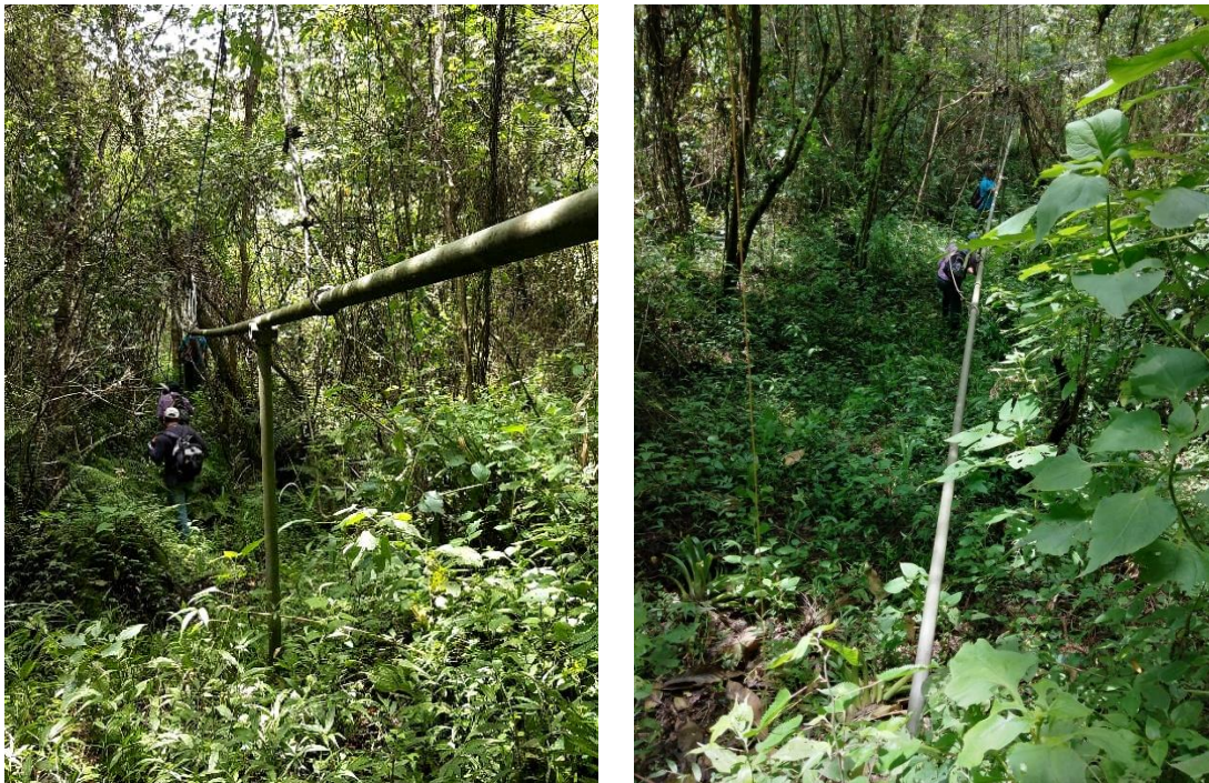
Figura 5 Paso aéreo del sistema
