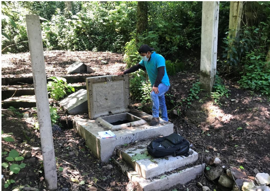
Ilustración 3. Obra de arte para la captación de la fuente, requiere realizar limpieza general de alrededores
