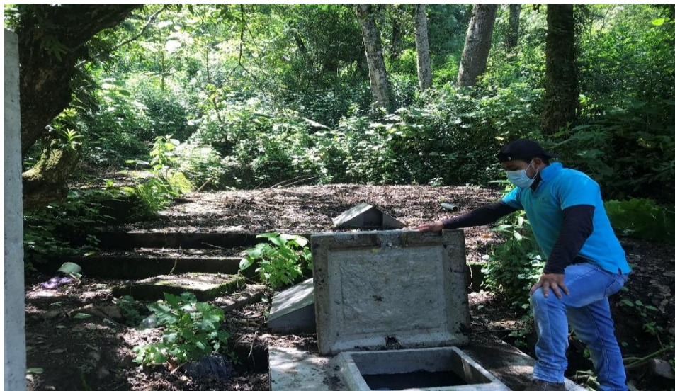
Ilustración 4. Captación, y caja unificadora de caudales, requieren limpieza general.
