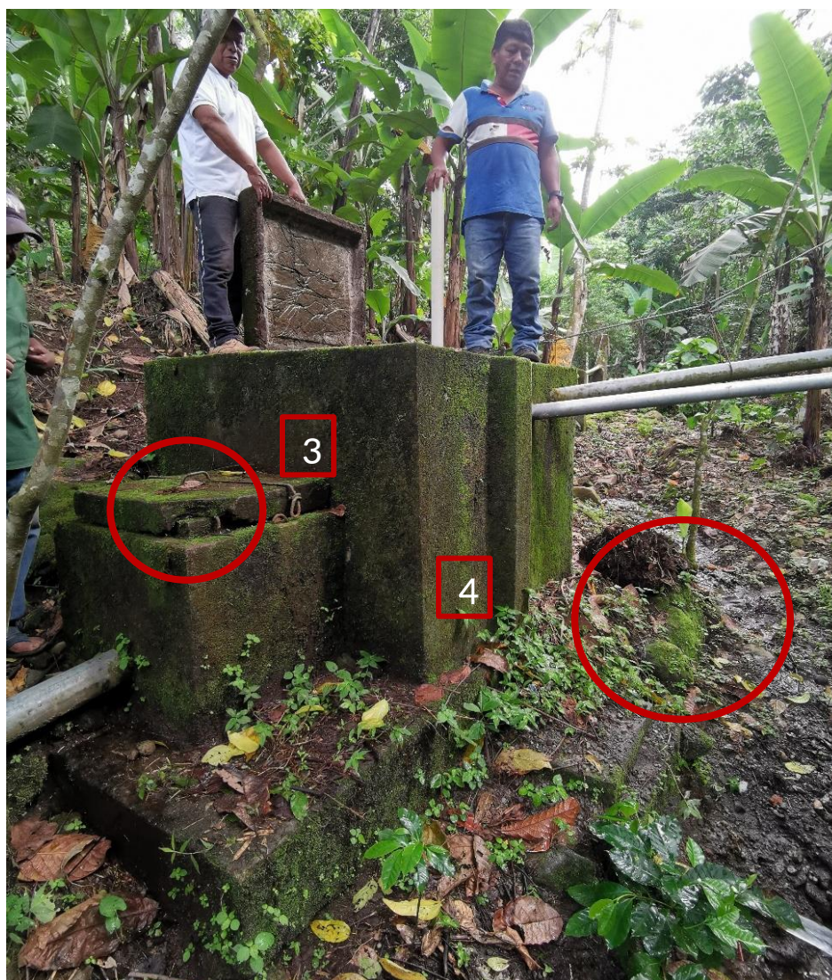
Fotografía 2: Condición de caja reunidora de caudales
