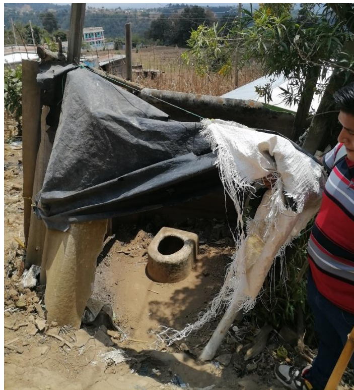
Fotografía 8. Letrina de vivienda en mal estado Elaboración propia.
