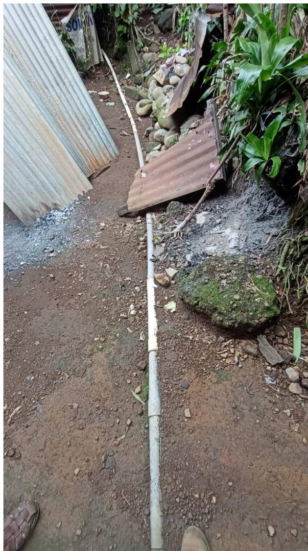
Fotografía 3. Red de distribución vieja y expuesta presenta continuamente fallas y roturas. Elaboración propia.
