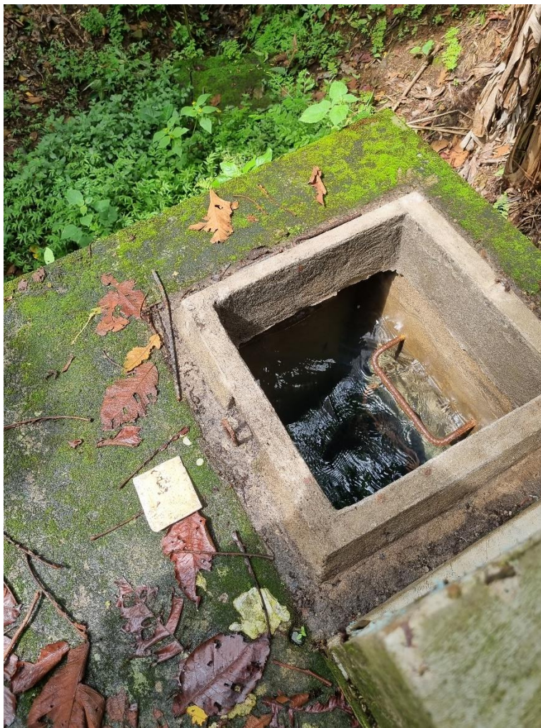
Fotografía 2. No se cuenta con sistema de desinfección. Elaboración propia.
