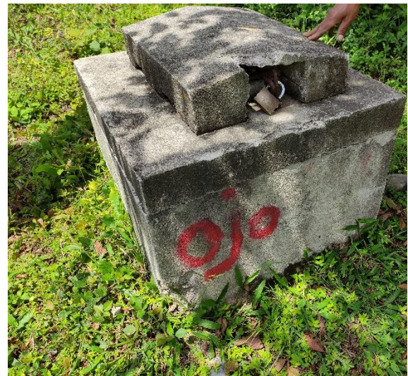
Ilustración 8: Fotografía la caja con válvula de limpieza
