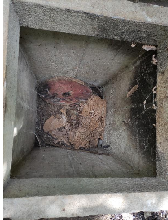
Ilustración 6: Fotografía de la caja con válvula de aire (no cuenta con válvula de aire)
