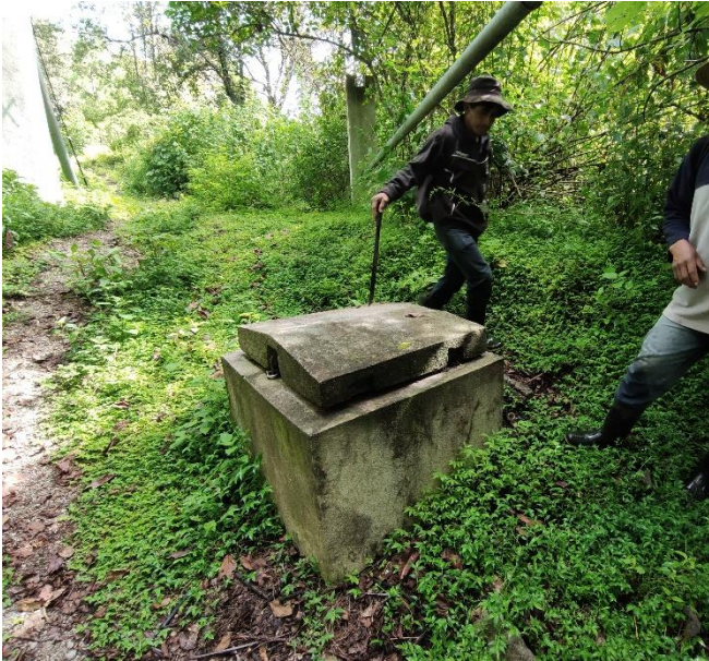
Ilustración 5: Fotografía de la caja de válvula de aire
