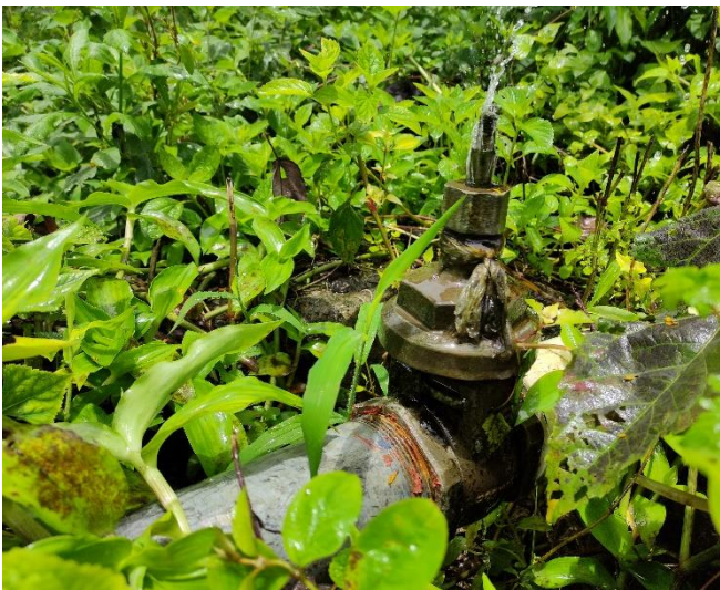
Ilustración 7: Fotografía del estado de la válvula de limpieza
