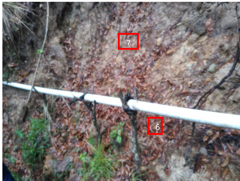
Fotografía 4. Vulnerabilidad de línea de conducción
