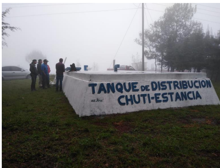
Fotografía 5. Vista del tanque de almacenamiento
