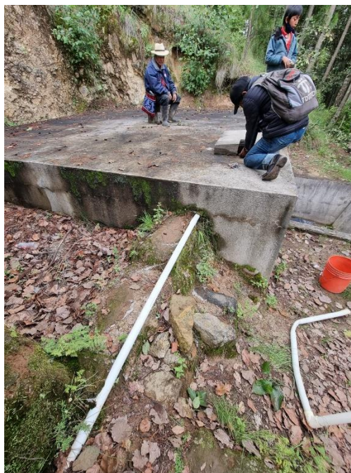
Fuente: Visita técnica 25/08/2021
