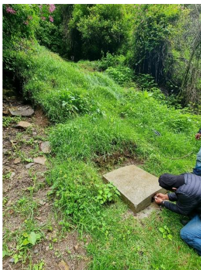
Fuente: Visita técnica 25/08/2021
