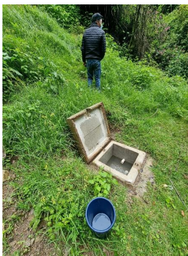
Fuente: Visita técnica 25/08/2021
