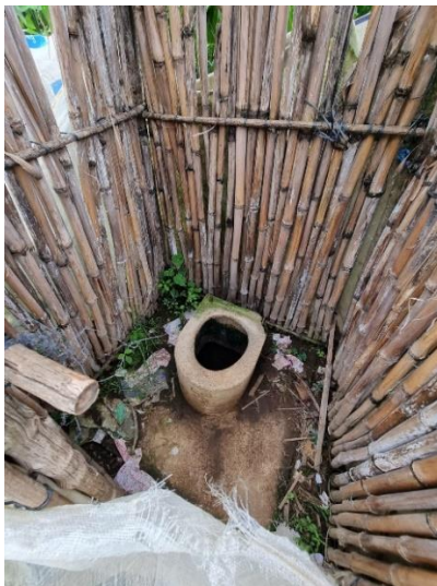
Fuente: Visita técnica 25/08/2021
