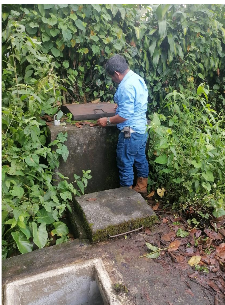
Fotografía 3. Caja de sistema de desinfección sin candado y sin mantenimiento.
