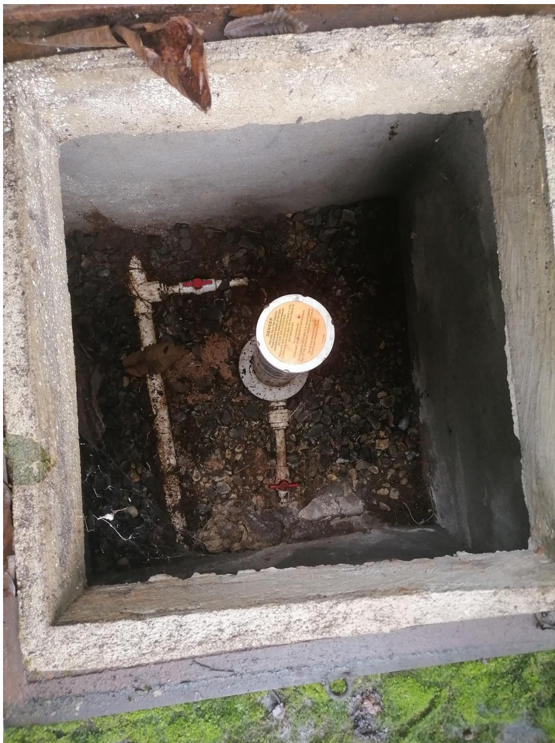
Fotografía 4. Sistema de desinfección sin funcionamiento ni mantenimiento.
