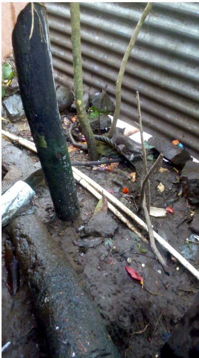
Fotografía 6. Tubería a flor de tierra en zona de desfogue de aguas grises.
