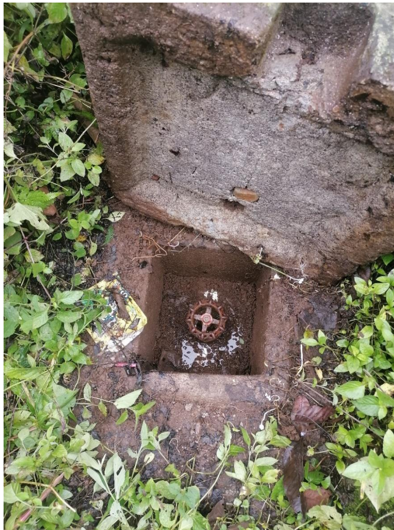
Fotografía 5. Llaves en mal estado, cajas sin limpieza.
