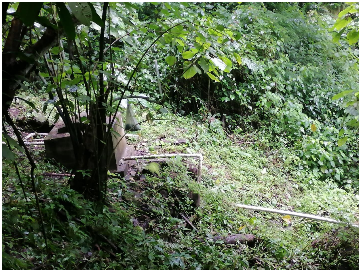
Fotografía 2. Captación 2, sin cerco y tubería expuesta.
