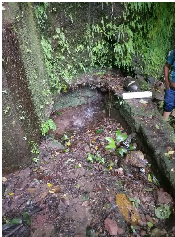
Fotografía 1. Captación 1, sello superior fallado por deslave rocoso.
