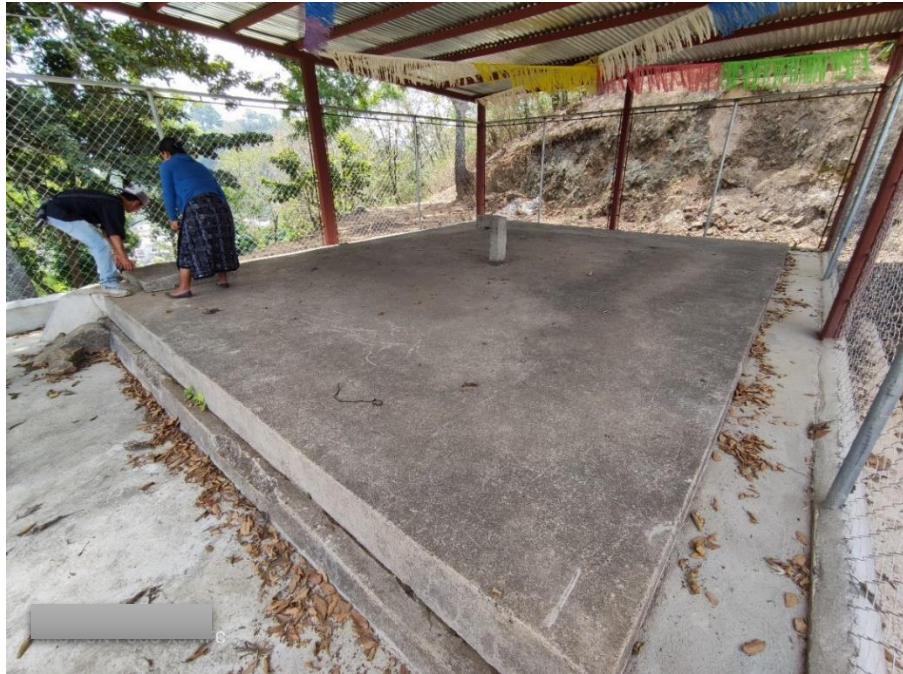
Ilustración 8: Fotografía del tanque de distribución del Cantón San Gabriel
