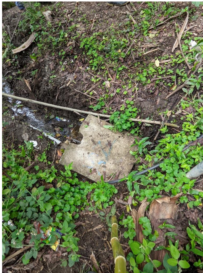
Ilustración 6: Fotografía del estado actual de las válvulas de aire
