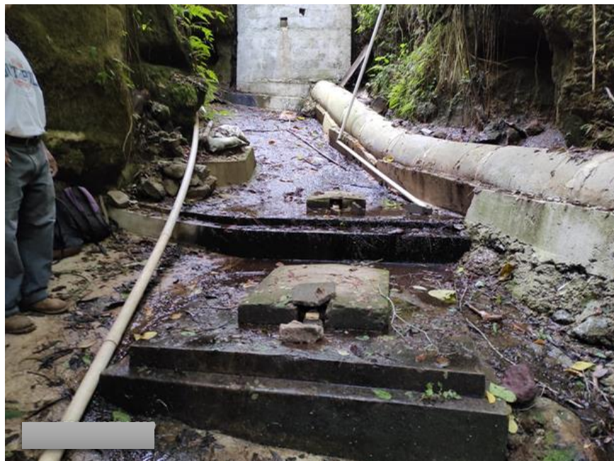
Ilustración 5: Fotografía de riesgo en la captación
