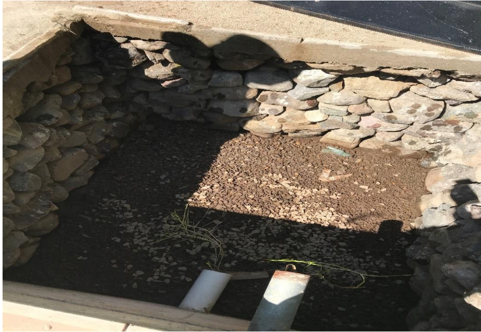
Ilustración 3. Captación del sistema, necesita limpieza general
