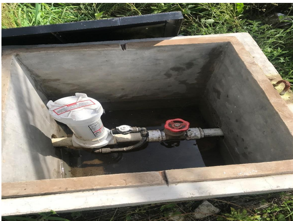
Ilustración 5. Unidad de cloración, sin operación, por falta de presupuesto e ideología cultural
