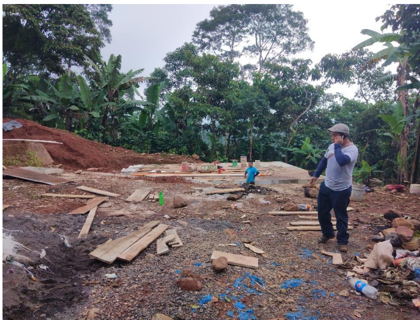
Fotografía 5. Área de tanques de distribución sin circulación.
