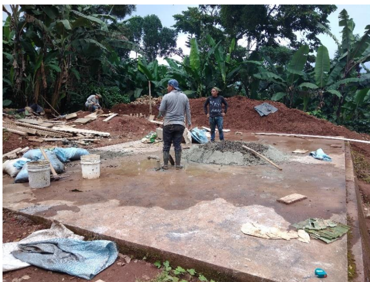
Fotografía 6. Tanque de distribución sin sistema de desinfección.
