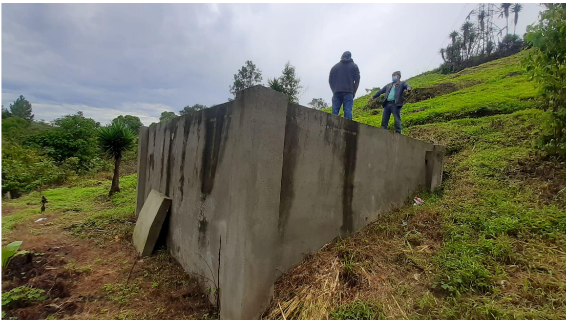
Fotografía 3 Vista del tanque de almacenamiento
