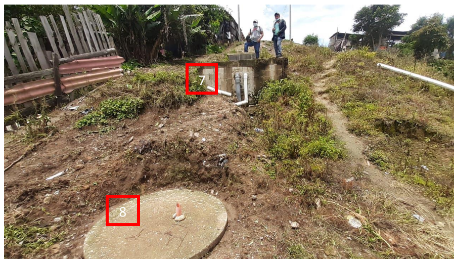
Fotografía 6. Sistema de tratamiento de aguas grises.
