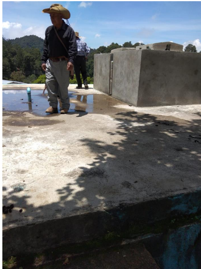
Figura 4 Tanque de distribución del sistema
