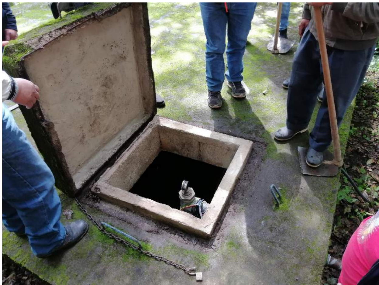
Fotografía 5 Bomba sumergible del sistema primavera
