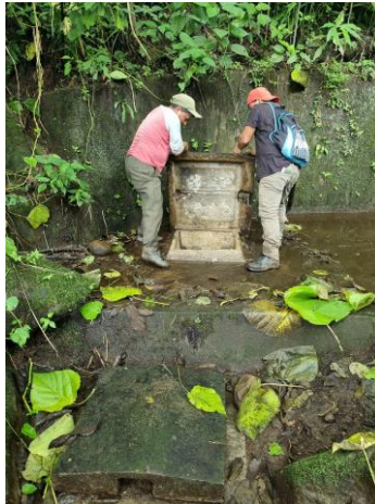
Fotografía 1. Riesgo de contaminación por obra de captación Pa Om dañada Elaboración propia.
