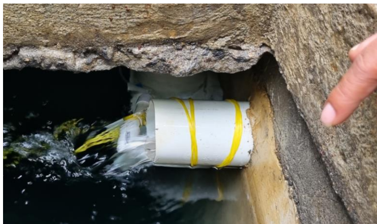
Fotografía 4. Tanque de distribución existente, sistema de desinfección mal instalado Elaboración propia.
