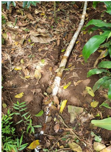
Fotografía 3. Riesgo de rotura en línea de conducción por malas prácticas en construcción. Elaboración propia.
