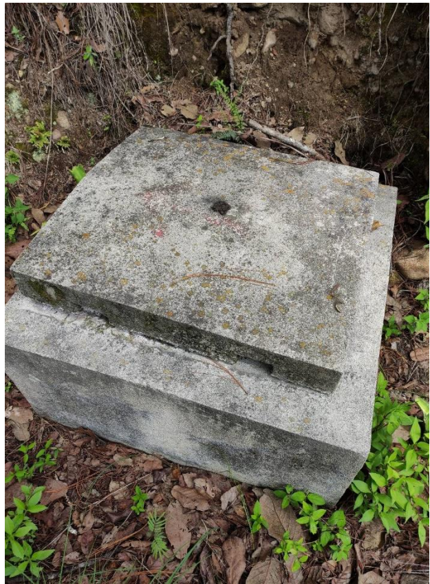
Ilustración 10: Fotografía del estado caja de válvula de aire
