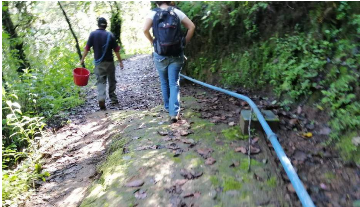
Fotografía 6 Línea de bombeo sistema de agua Chuimachá y Pachipac
