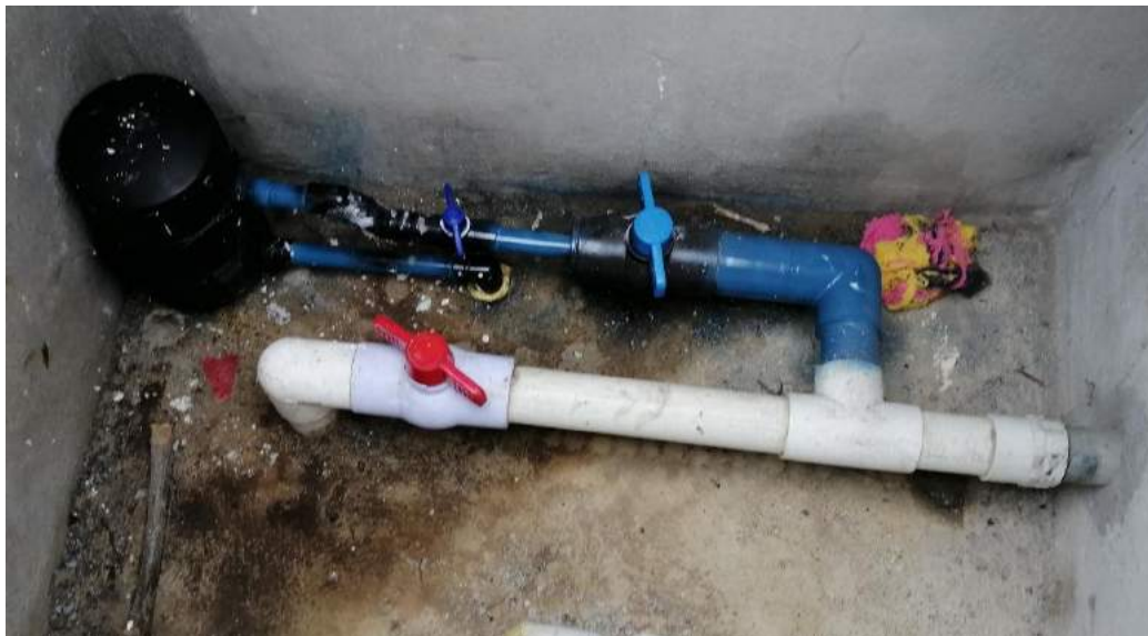
Fotografía 5 Clorador sobre el taque de distribución del sistema de Chuimachá y Pachipac
