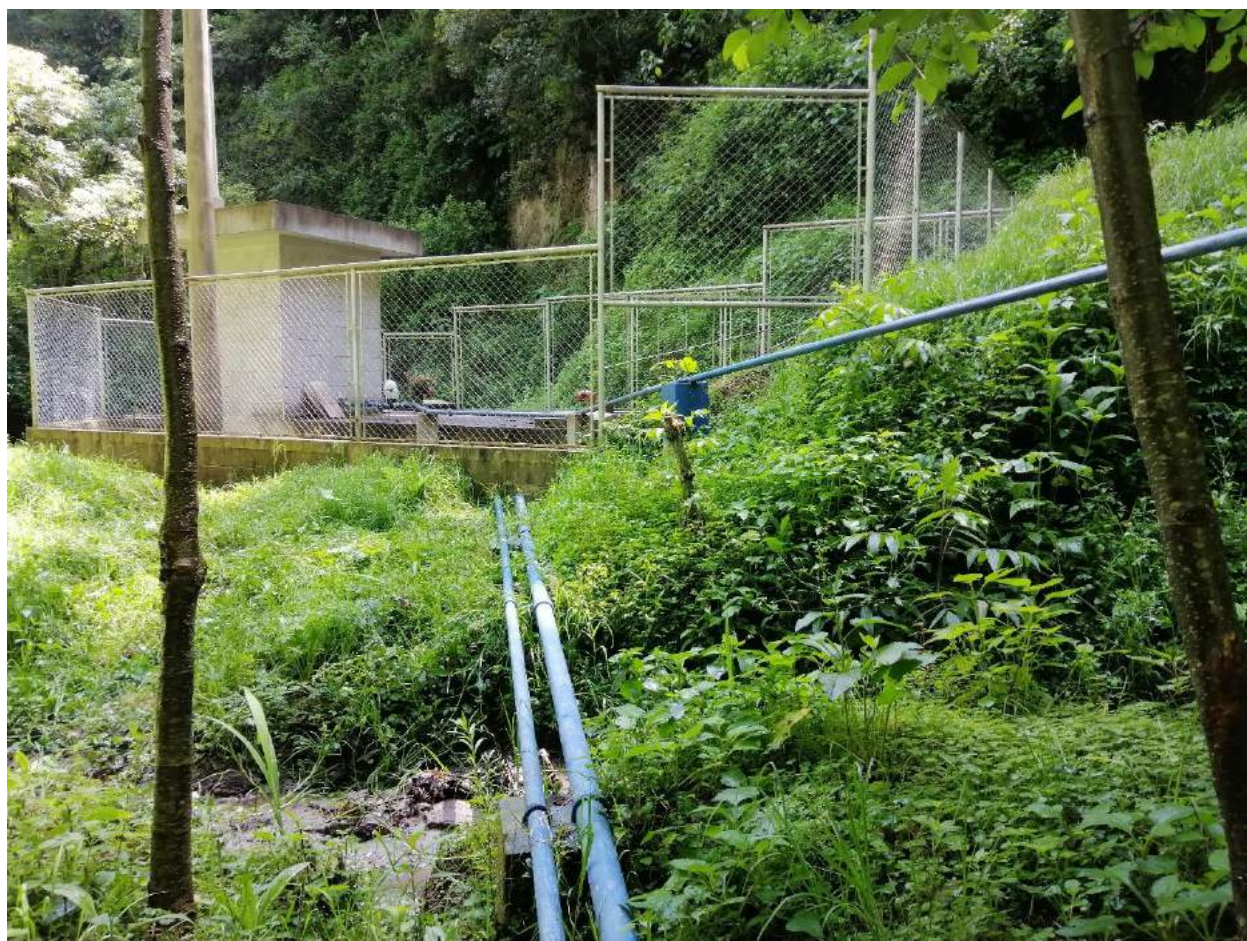
Fotografía 2 Tanque de succión
