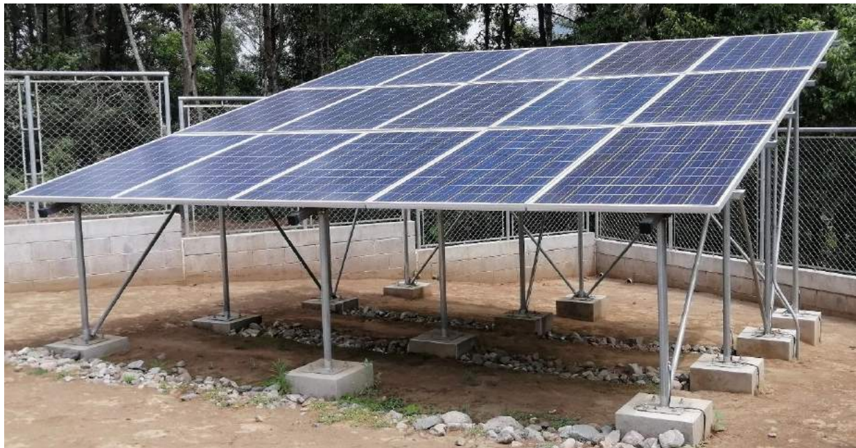
Fotografía 9 Banco de paneles solares
