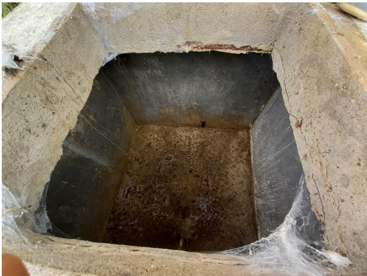
Fotografía 5. Existe espacio físico para sistema de desinfección, pero no tiene sistema de desinfección. Elaboración propia.
