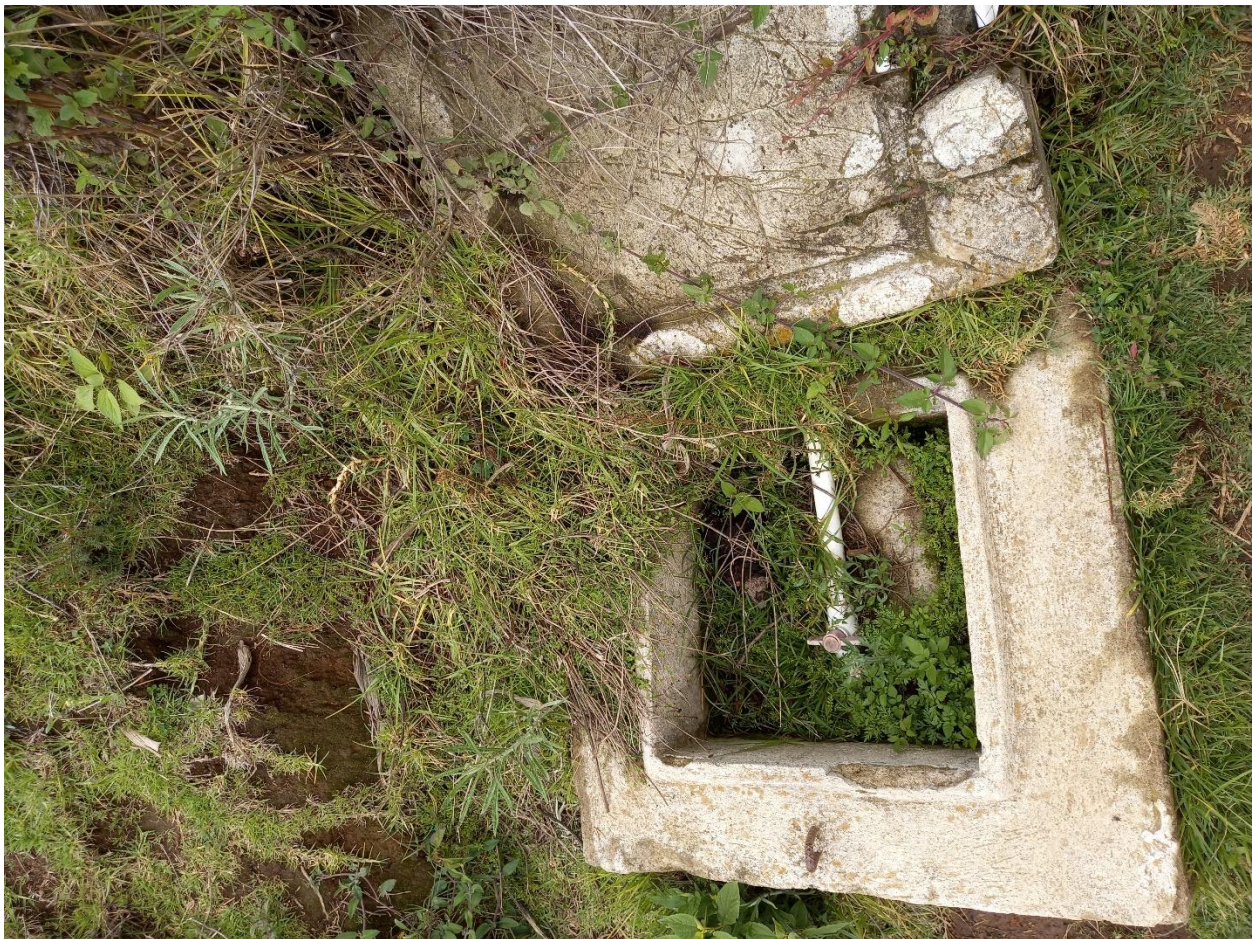
Fotografía 6. Cajas de válvulas en mal estado.
