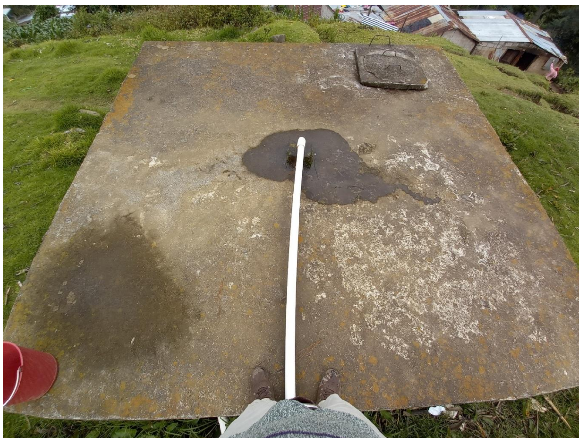
Fotografía 4. No existe espacio físico para sistema de desinfección en tanque 1.
