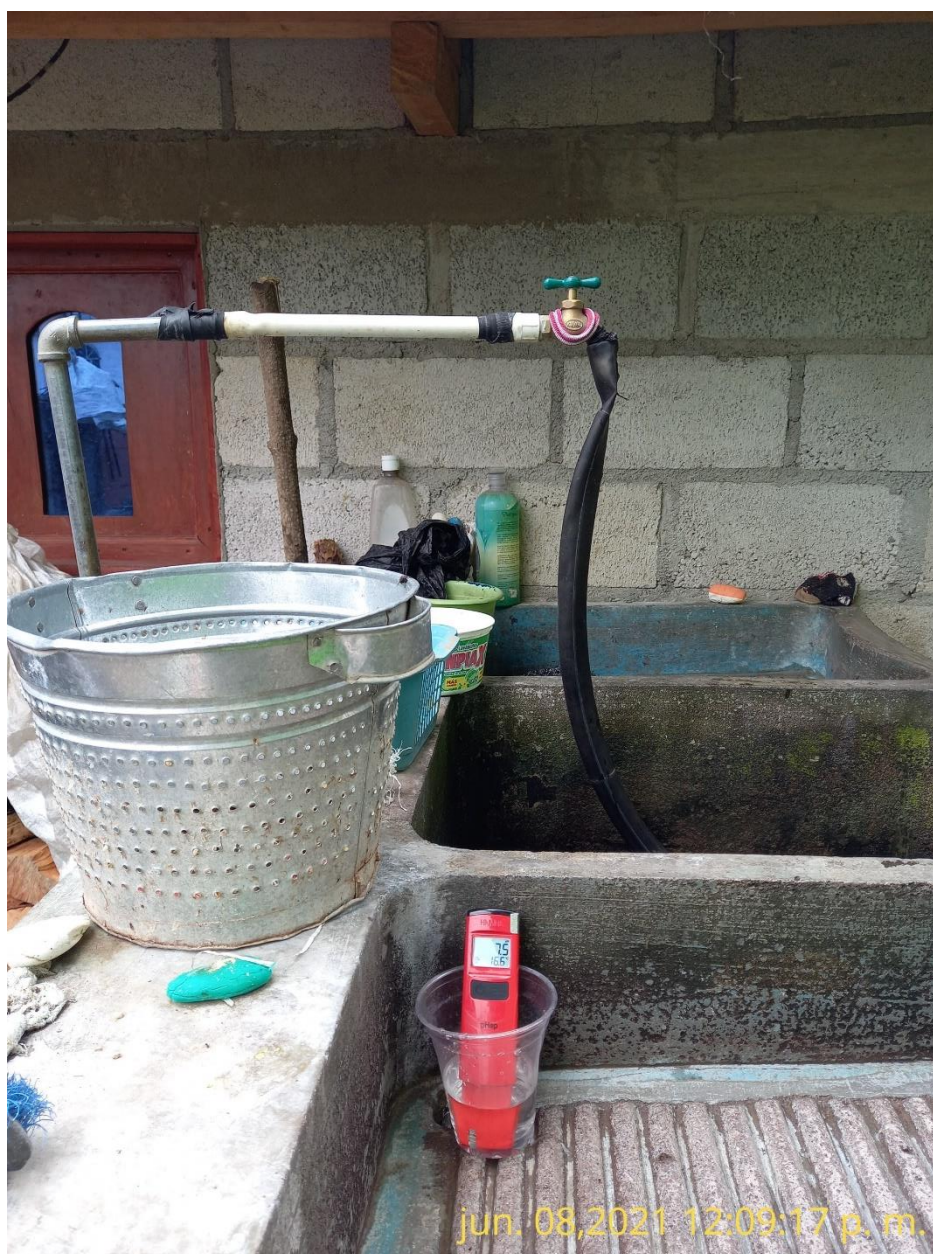
Fotografía 7. Conexiones domiciliarias con fugas. Elaboración propia.
