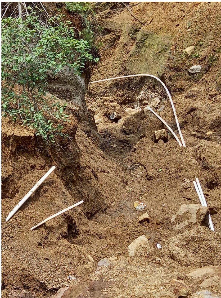
Fotografía 2. Captación con riesgo de inundación y deslaves. Elaboración propia.
