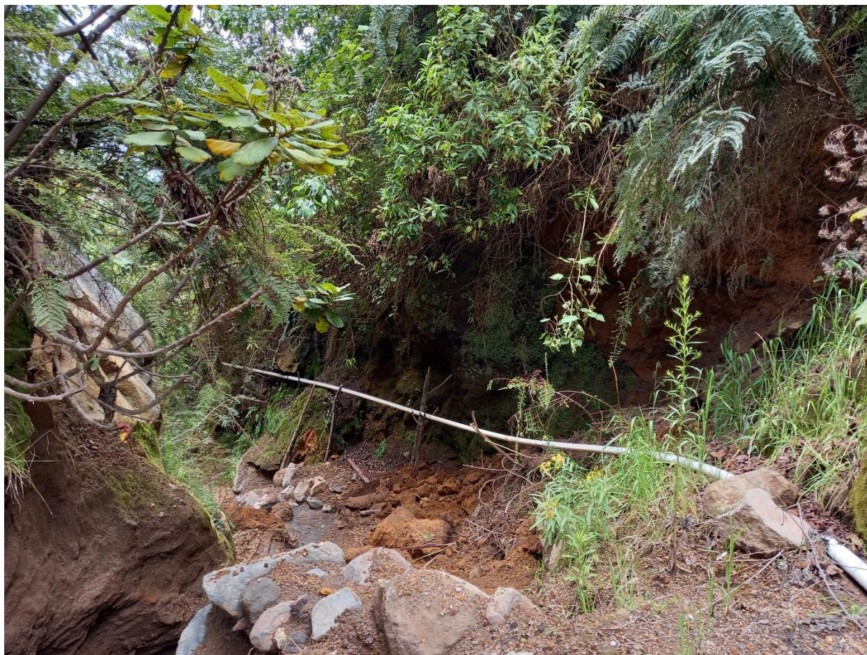
Fotografía 3. Tubería expuesta toda la línea de conducción. Elaboración propia.
