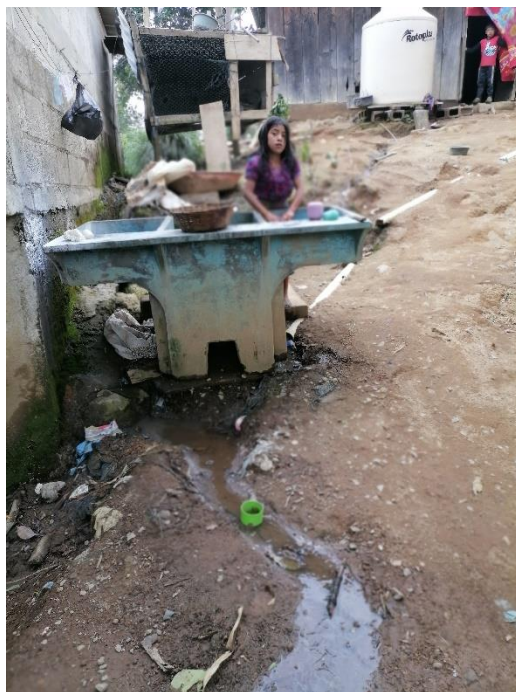
Fotografía 7. Pila donde se observa el agua corriendo a flor de tierra
