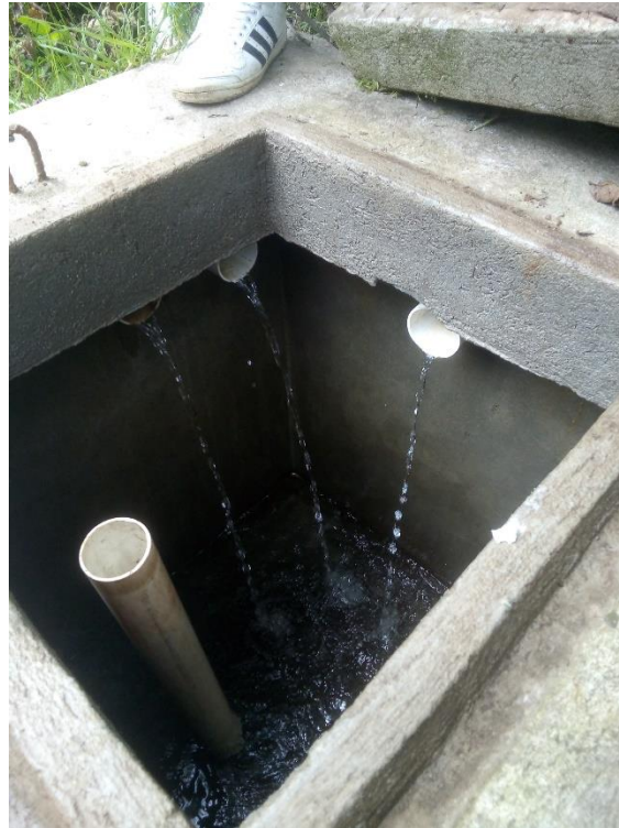
Fotografía 2. Caja reunidora de tres captaciones
