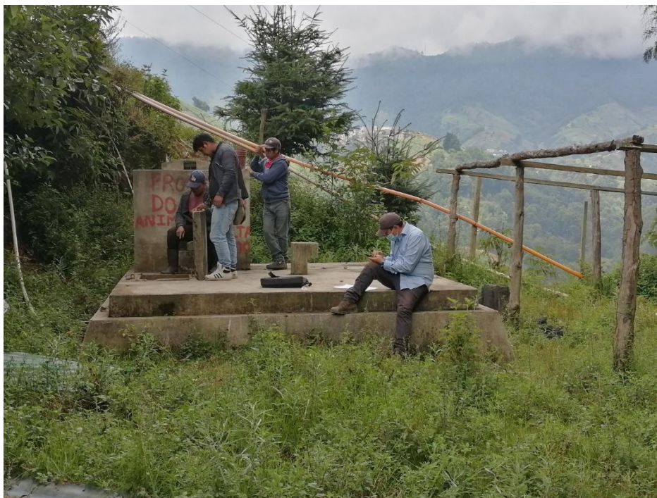
Fotografía 4. Tanque de distribución sin cerco perimetral.
