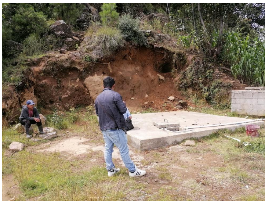
Fotografía 5. Tanque de distribución 2 sin cerco perimetral.
