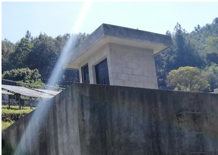
Fotografía 9 Tanque de succión, bomba sumergible
