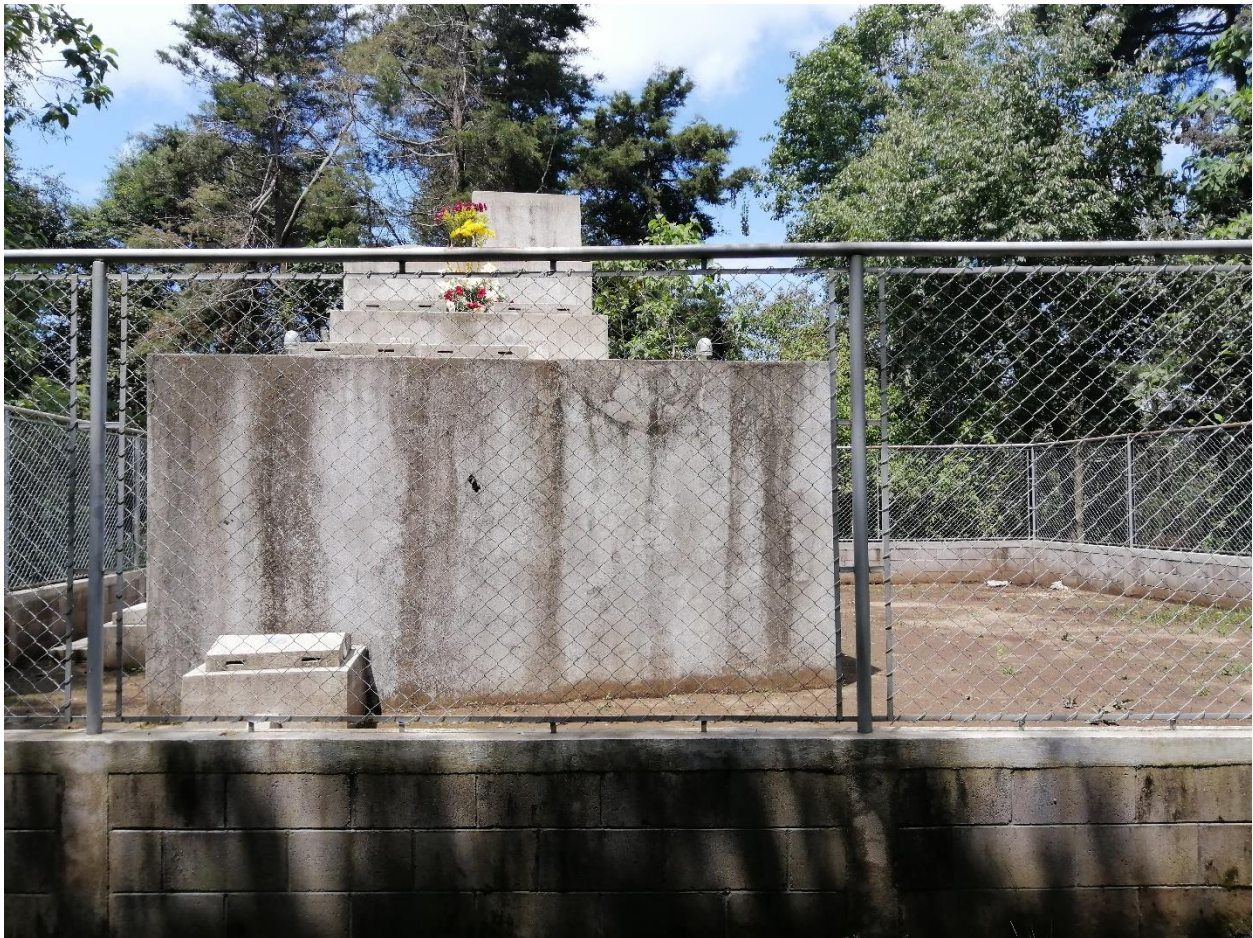
Fotografía 3 Tanque de distribución del sistema de agua
