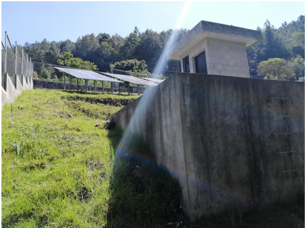
Fotografía 2 Tanque de succión y Paneles Solares
