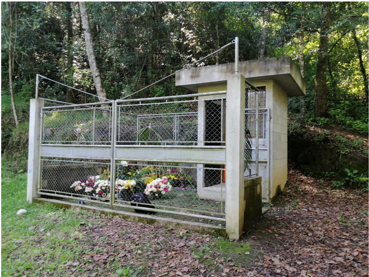
Fotografía 1 Caseta de bombeo más pozo mecánico
