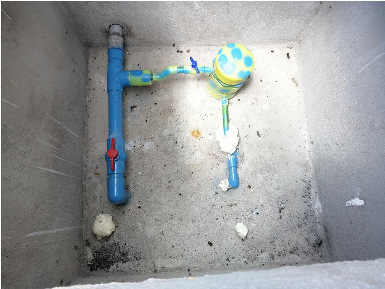
Fotografía 4 Unidad de cloración
