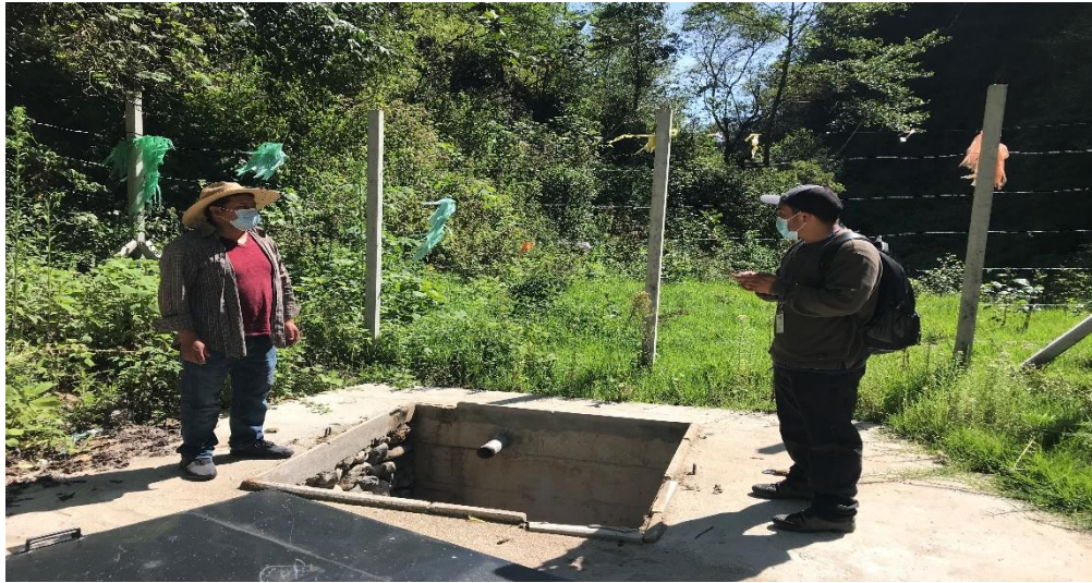
Ilustración 3. Captación del sistema, necesita limpieza general
