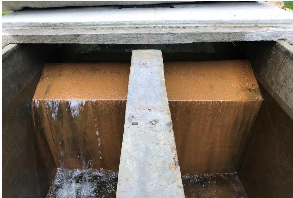
Ilustración 4. Se observa caja divisora de caudales.
