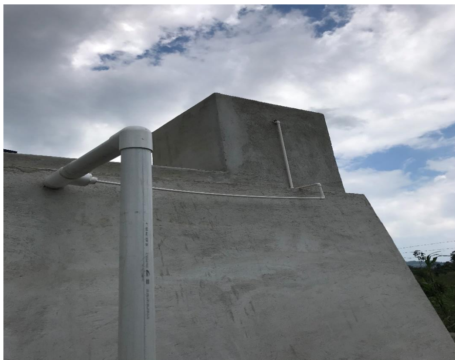
Ilustración 5. Unidad de cloración, sin operación, por falta de entrega del proyecto e ideología cultural.
