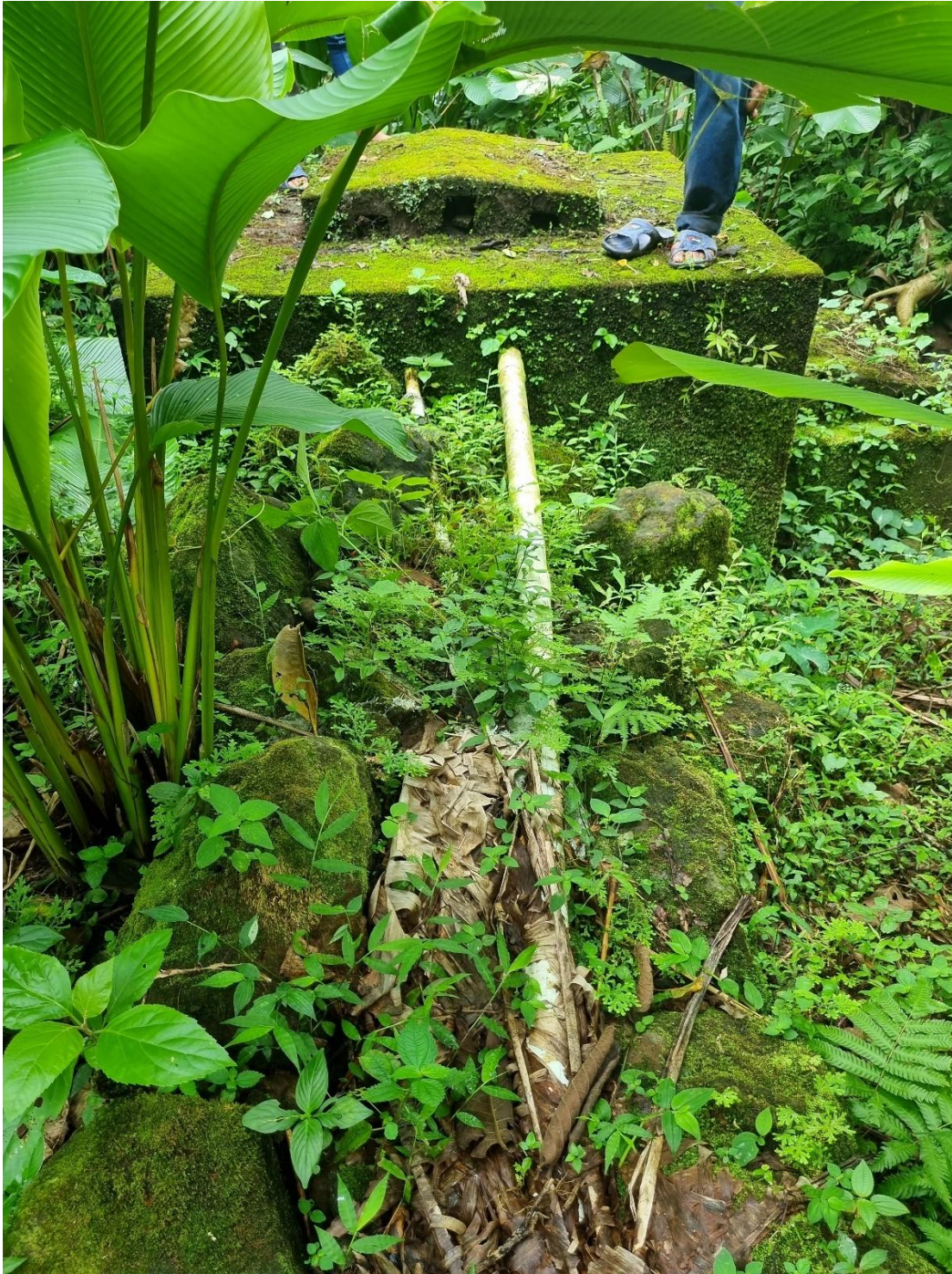
Fotografía 3. tubería expuesta vulnerable a rotura.
